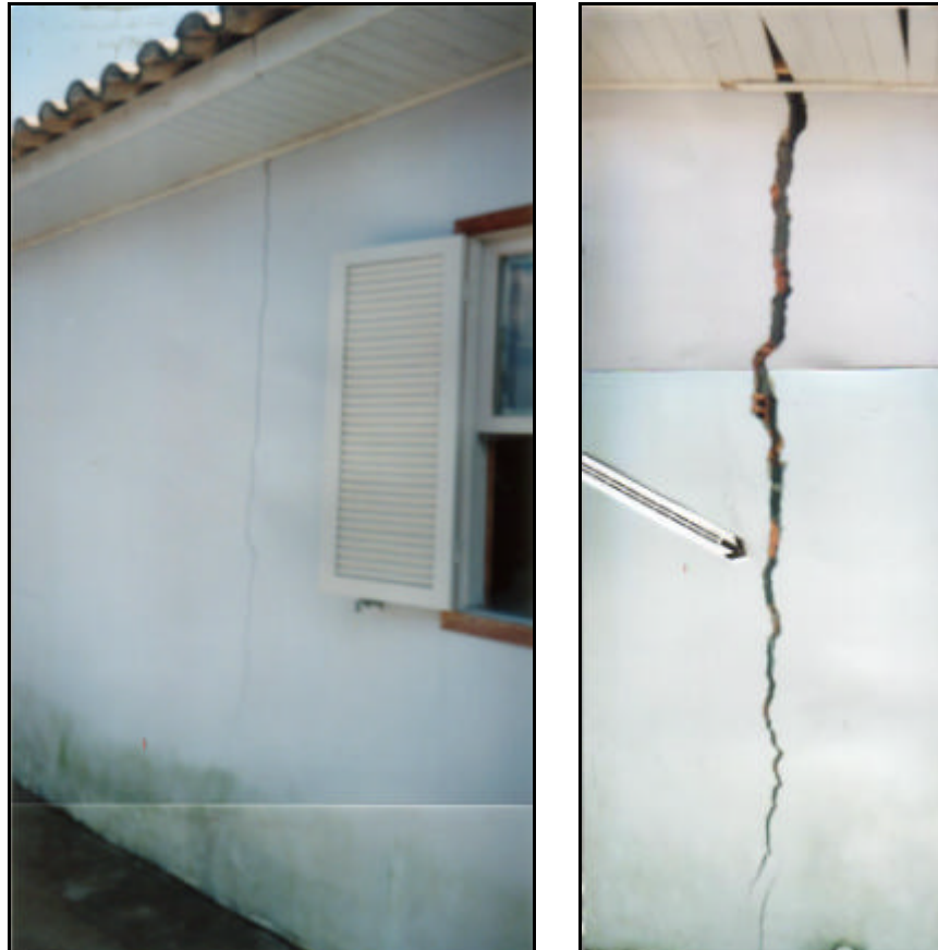
Figura 9 - Dano 9, verificado na parede Sul e detalhe da abertura
