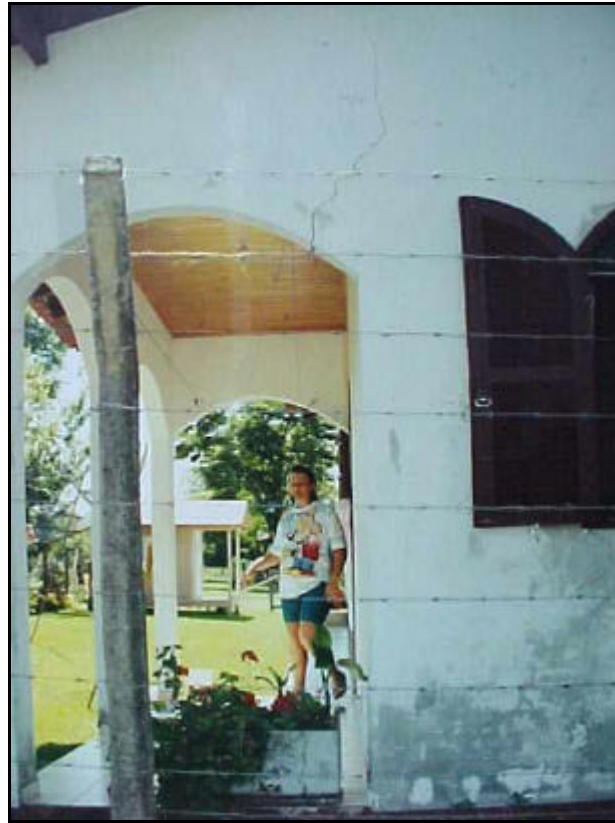
Figura 21 - Dano 3, Fissura vertical externa a edificação
