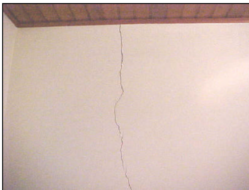
Figura 24 - Dano 8, fissura vertical na sala
