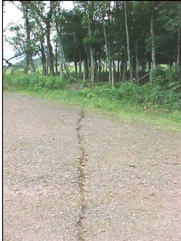
Figura 17 - Brecha na pista
