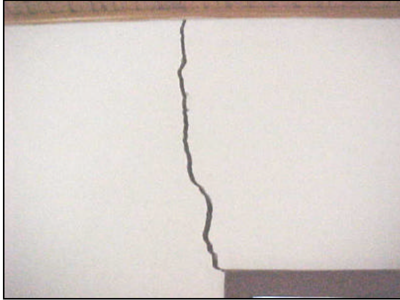
Figura 25 - Dano 9 - Fenda vertical sobre a porta
