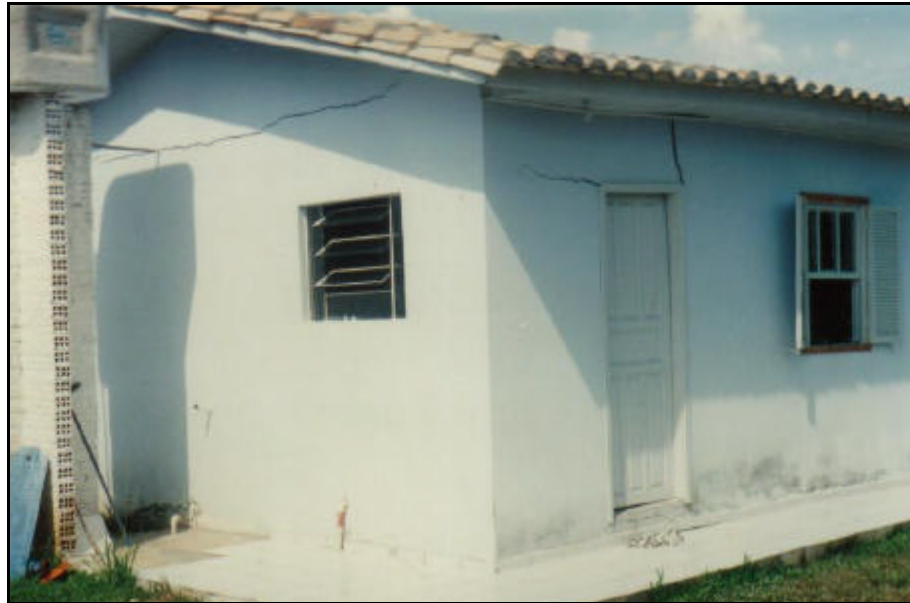
Figura 7 - Danos 6, 7, 8 e 10 nas paredes à Norte e à Leste
