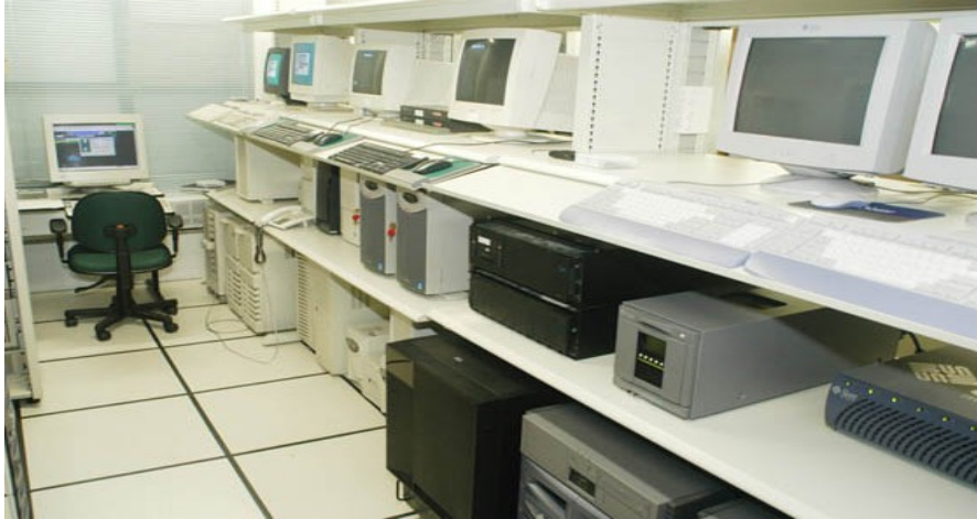
Figura 23 – Sala dos servidores em dezembro de 2002. Fonte: Prédio da Unimed BH, 2003.
