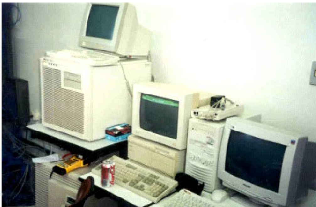
Figura 14 – Foto do Centro de Processamento de Dados.
