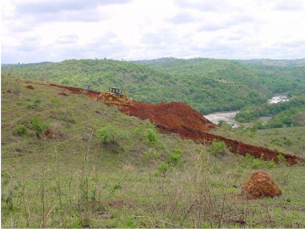
Foto 4: Desmatamento da região da obra com vista parcial do Rio São Marcos.
