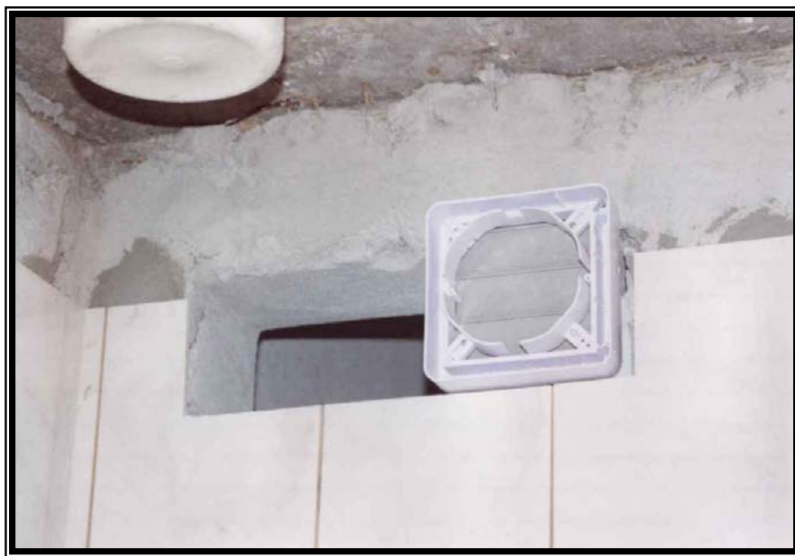
Figura 5.2 – Exemplo de um problema que poderia ter sido gerado pela negligência com a antecipação de adequação do projeto de instalação do exaustor do banheiro à sua execução
