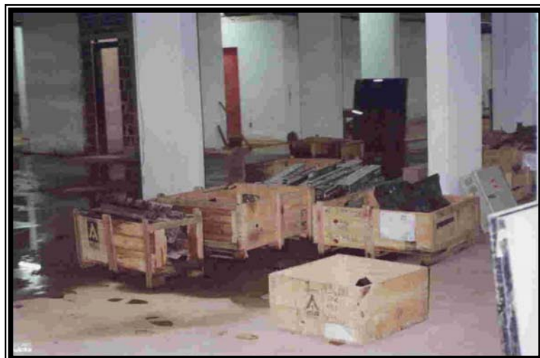
Figura 5.28 – A consequência da negligência com a antecipação de drenagem
