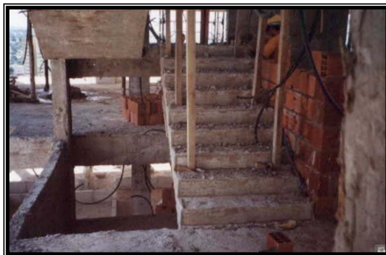
Figura 5.14 – A antecipação de execução da alvenaria da caixa de escada
