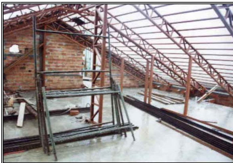
Figura B10 – A consequência da negligência em relação à conclusão da cobertura da obra.
