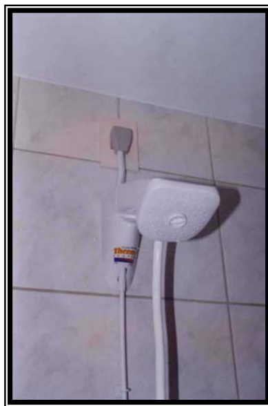
Figura 5.1 – Exemplo de uma complicação que poderia ter sido gerado pela negligência com a antecipação de adequação do projeto de instalações elétricas à execução
