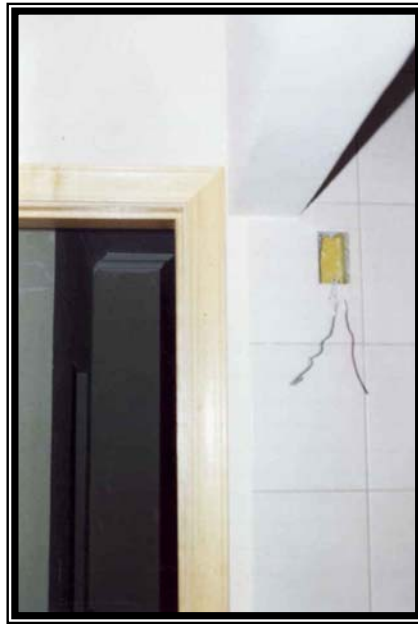
Figura 5.3 – O problema que poderia ter acontecido em função da negligência com a antecipação de adequação do projeto de fixação da porta considerando a distância adequada à viga
