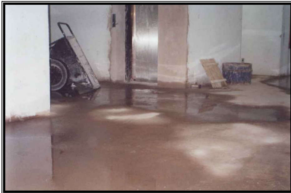
Figura 5.29 – A negligência com a antecipação de drenagem aparecendo de forma recorrente
