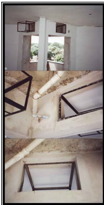
Figura 5.20 – Negligência com a antecipação de coordenação entre o projeto hidráulico e a definição da posição do suporte do condicionador de ar
