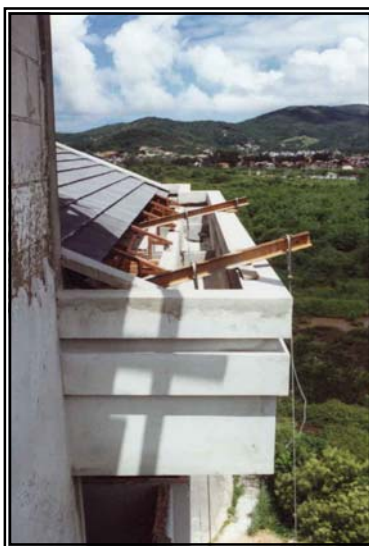
Figura B3 – O problema do acesso à fachada.
