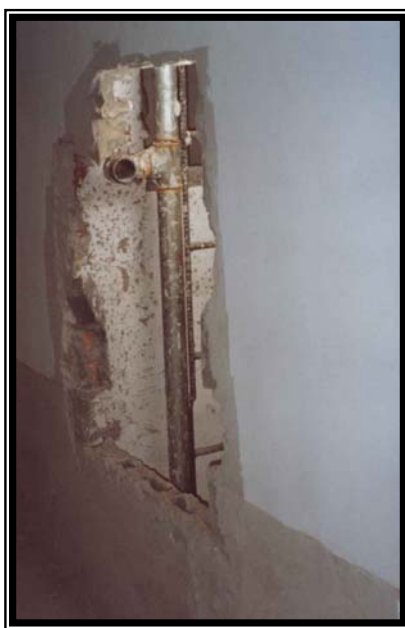
Figura 5.22 – Negligência com a antecipação de acessibilidade
