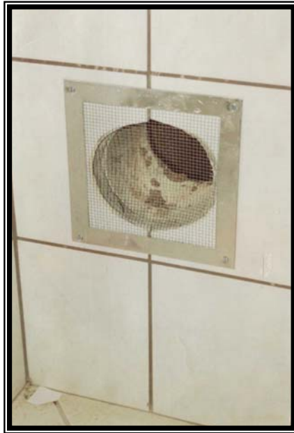
Figura 5.12 – A consequência gerada pela negligência com a antecipação de terminação e limpeza do duto de ventilação da área de serviço
