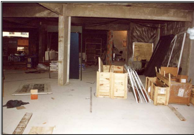
Figura B5 – A consequência da negligência com a antecipação de preparação de espaço físico para armazenagem de componentes do elevador da obra.
