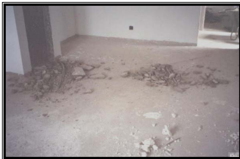
Figura 5.21 – Negligência com a antecipação de nivelamento do piso cimentado
