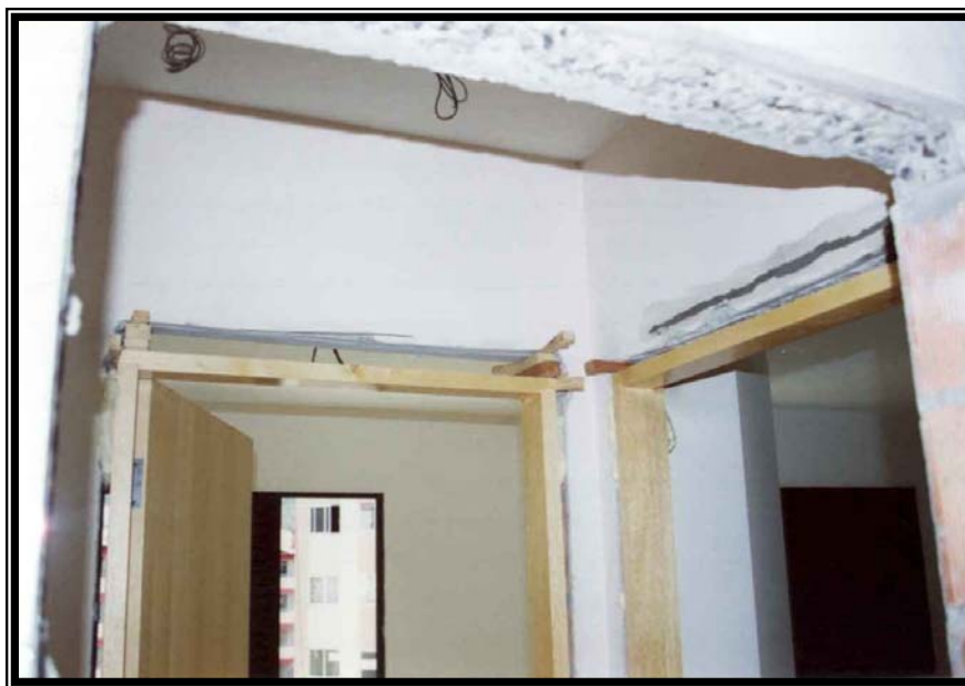
Figura 5.7 – O problema gerado na colocação de portais pela negligência com a antecipação de nivelamento
