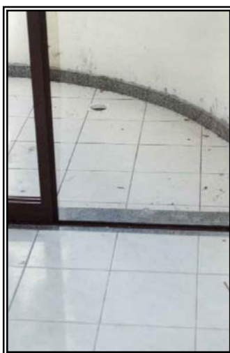
Figura B2 – O problema gerado pela negligência com a antecipação de coordenação entre os projetos hidráulico e de revestimento cerâmico da sacada.
