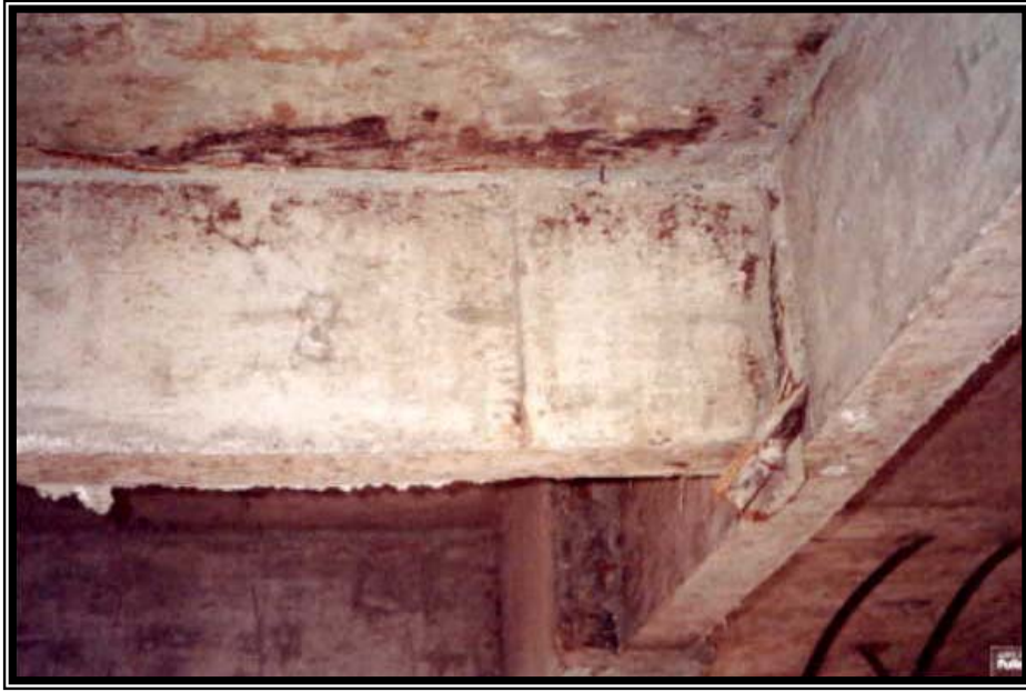
Figura 5.16 – A consequência da negligência com a antecipação de inspeção de fôrmas reutilizáveis sobre a superfície da peça estrutural de concreto armado
