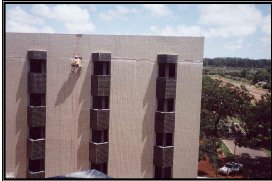
Figura 5.23– Negligência com a antecipação de terminação na execução do serviço de assentamento cerâmico de fachada, gerando um retrabalho
