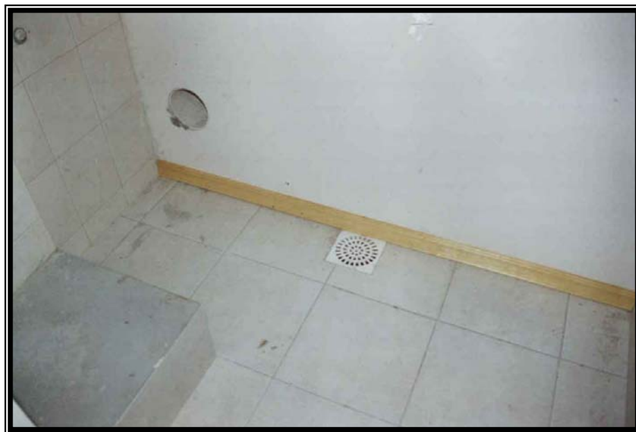
Figura 5.4 – O problema gerado pela negligência com a antecipação de coordenação entre o projeto hidráulico e o projeto de acabamento da parede
