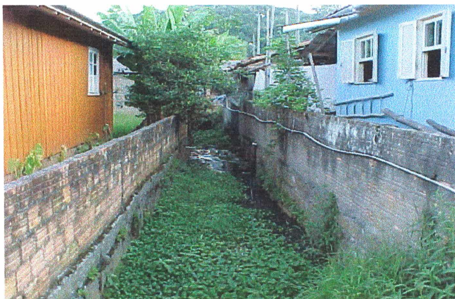
FOTO 3 - Vala negra para onde é destinado o esgoto das residências.
