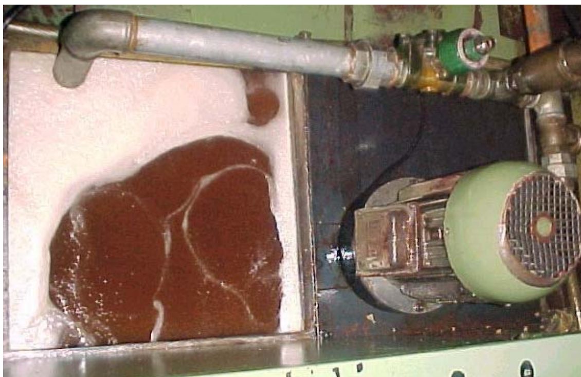
Figura 38 – Bomba de fluido refrigerante de baixa pressão e alta vazão.
