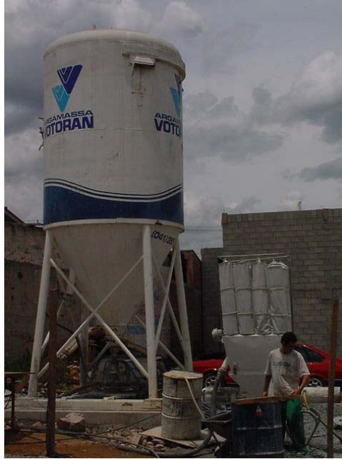
Figura 32: Silo para armazenagem da argamassa para projeção
