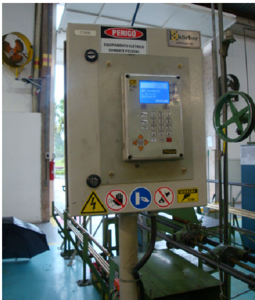
Figura 4.18 – CLP do SMATR instalado ao lado da máquina monitorada para a aquisição de sinais
