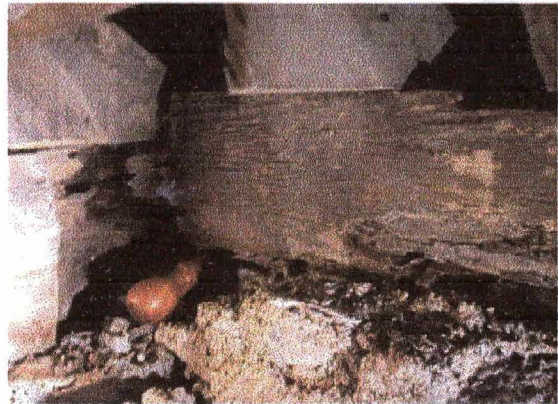
Figura 3: foto mostrando apodrecimento no frechal e na ponta da tesoura principal sul
