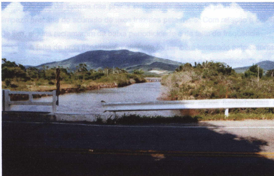
Foto 25: Estrangulamento dos rios através da construção de pontes com vãos mal dimensionados. SC 401 ao fundo e SC 402 em primeiro plano.
