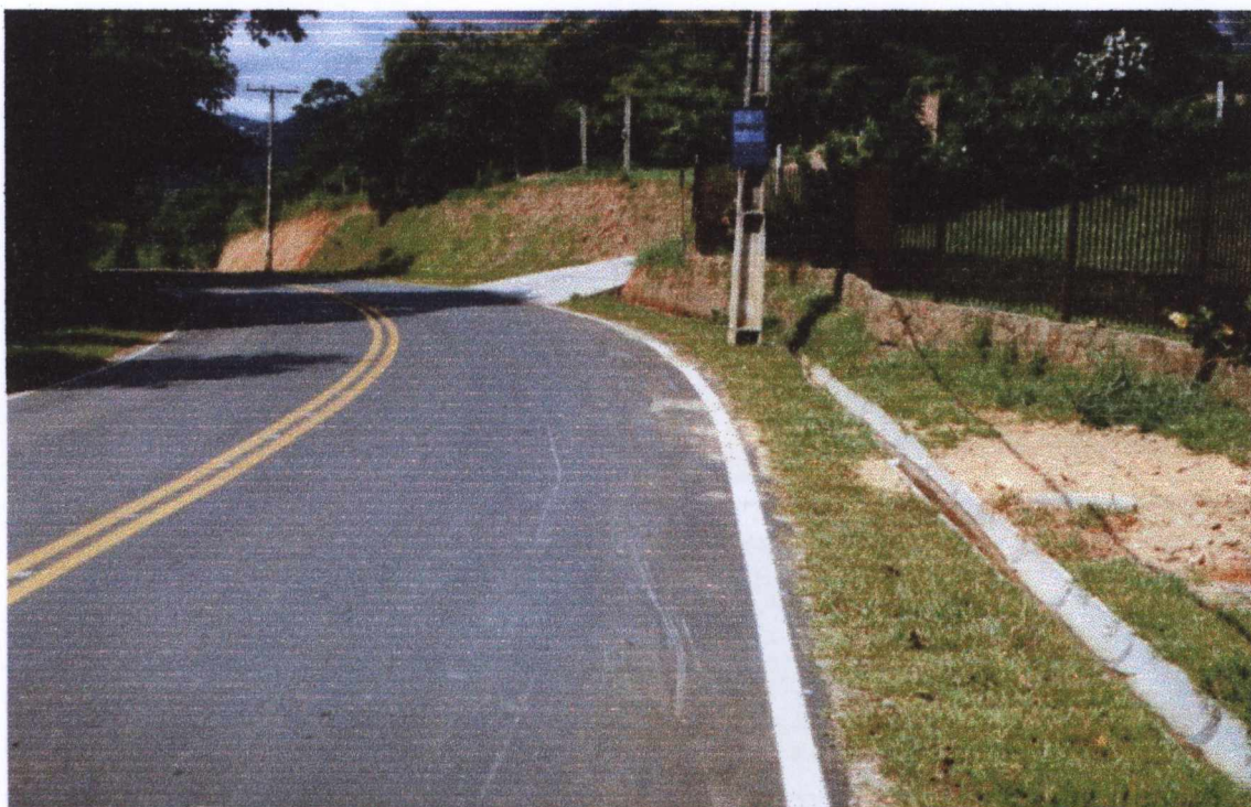
Foto 23: Obras de pavimentação e drenagem em andamento no interior de Rationados. SC 401 ao fundo e SC 402 em primeiro plano.
