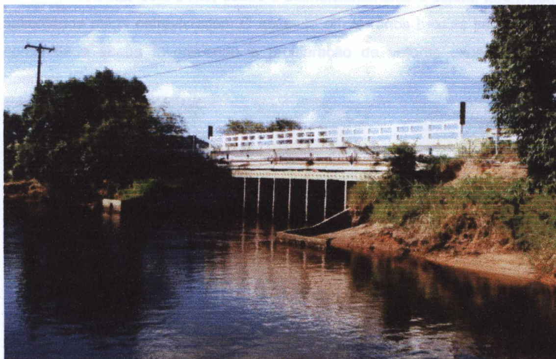
Foto 24: Comportas sob pontes da SC 402, dificultando o fluxo de águas.
