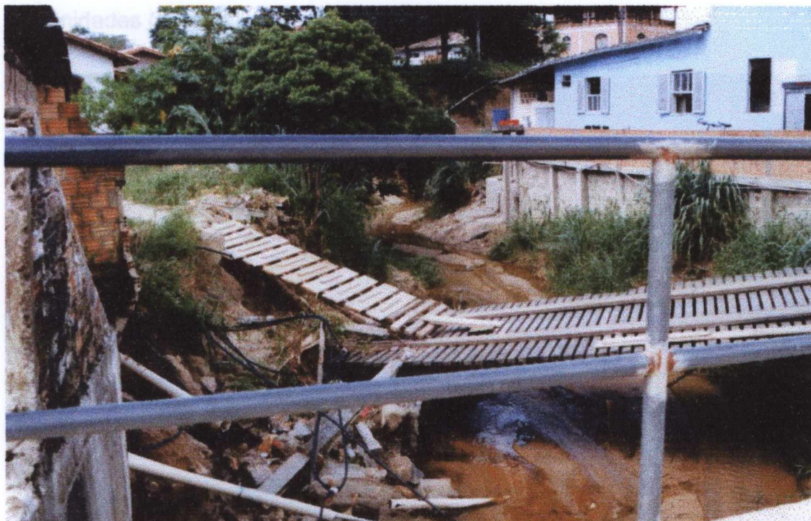
Foto 20: Ocupação das margens dos córregos, com lançamento de dejetos e desmatamento das matas ciliares ocasionando erosão (Ratones).
