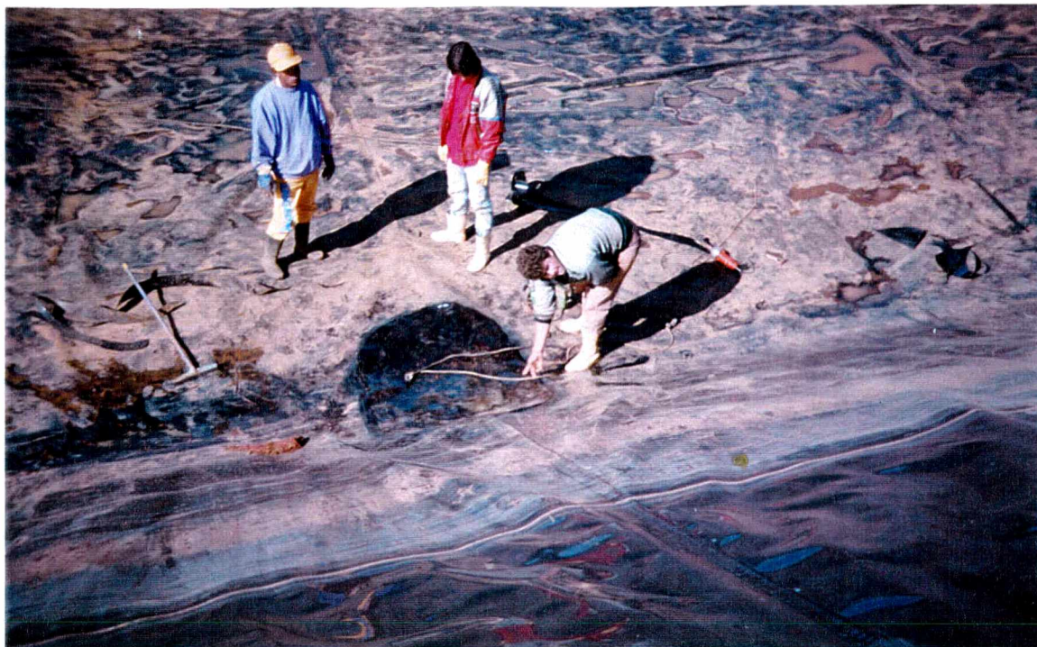
Foto 36 - Trabalhadores procedendo ao remendo de um dos quatro rasgos na lona do tanque de decantação do aterro sanitário de Chapecó (Foto: Jornal Sul Brasil, julho de 2000).
