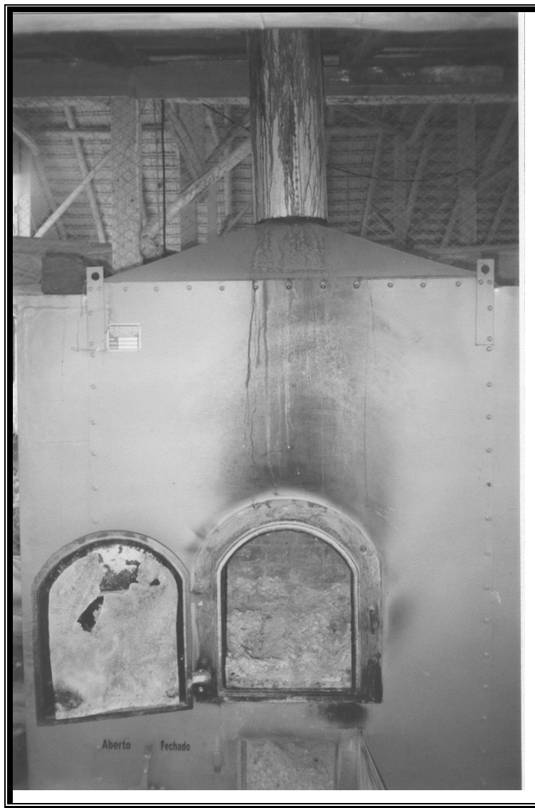
Foto 10 - Com a fornalha o avicultor reduz suas inúmeras idas ao aviário para alimentar o aquecedor com lenha. A fornalha possui um sistema de fechamento bastante eficiente permitindo assim, aproveitar o máximo possível do calor produzido com a queima da lenha.
