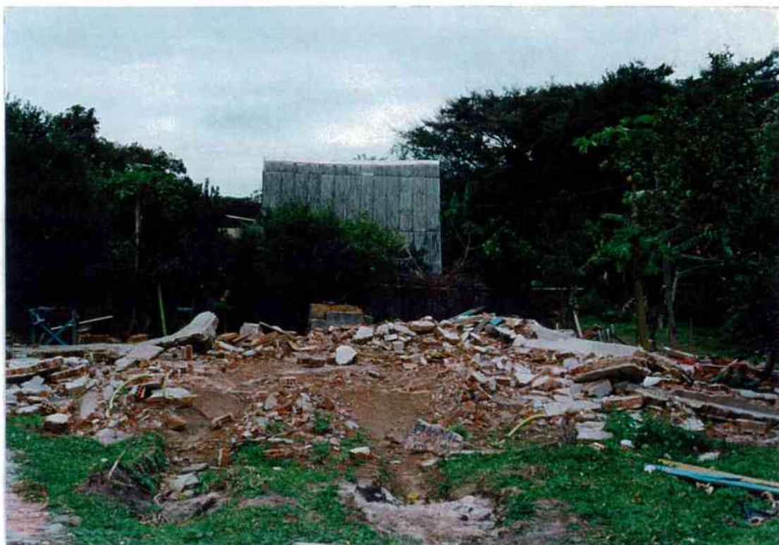
Figura 14: Escombros de uma casa demolida ("seo Getúlio")
