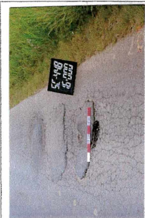
Foto 20 Remendos, panela e trinca tipo "couro de jacaré" Classe 3 Lado Direito
