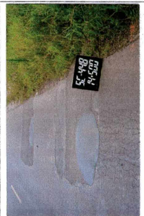
Foto 16 Remendos e trinca tipo "couro de jacaré" Classe 3 Lado Direito
