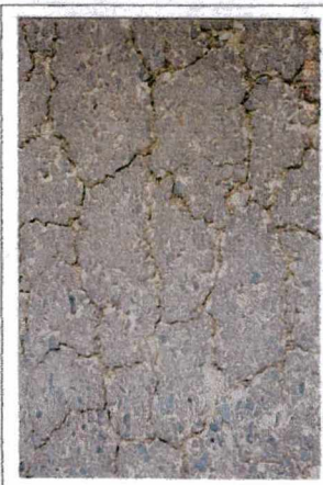
Foto 13 Trinca tipo "couro de jacaré" Classe 3 DETALHE - Lado Direito
