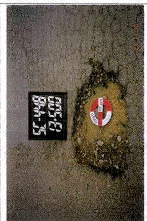
Foto 15 Panela DETALHE - Lado Esquerdo
