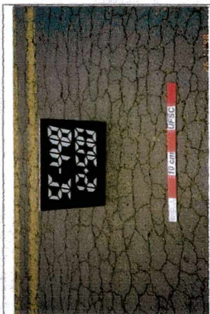
Foto 10 Trinca tipo "couro de jacaré" Classe 3 Lado Direito
