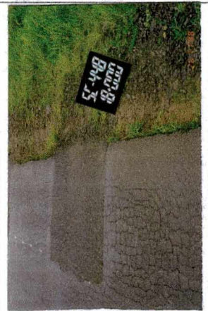
Foto 23 Remendo e trinca tipo "couro de jacaré" Classe 3 Lado Direito
