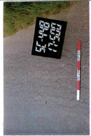
Foto 22 Trinca tipo "couro de jacaré" Classe 2 Lado Direito
