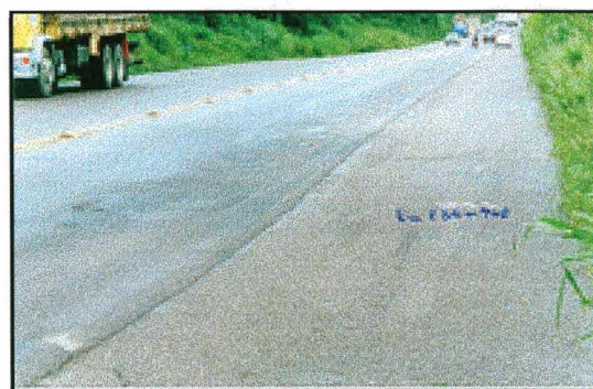
Fig.8.1.3.6.- Defeito: Afundamento Plástico Local c/ escorregamento do Asfalto. As marcas de frenagem no acostamento e pista indicam risco.
