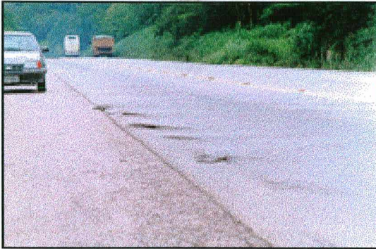
Fig. 8.1.3.7. Difeitos: Afundamento Plástico de Trilha de Roda c/Escurregamento do Revestimento
