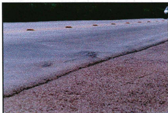
Fig. 8.1.3.3.- Defeitos:Corrugação e Afundamento Plástico Local
