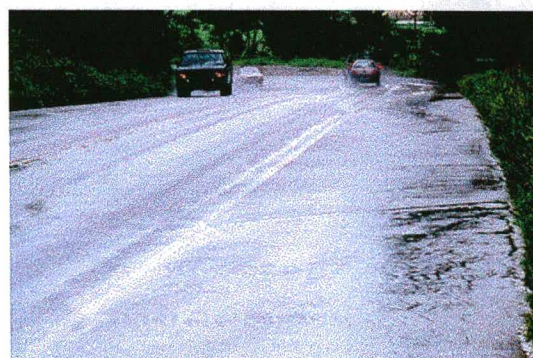
Fig. 8.1.3.4.- Vista da Aproximação da Curva nº19 Defeito: Afundamento Plástico Local; Deformação da pista e do acostamento, lado direito; Escoamento d'água pelo acostamento..
