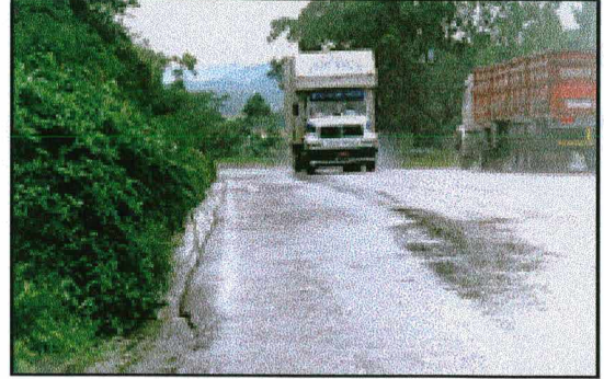
Fig. 8.1.3.8. Difeitos: Desgaste do Pavimento e Afundamento Plástico de Trilha de Roda
