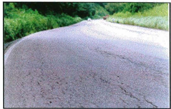
Fig.8.1.3.10. Difeito: Trincas Couro de Jacaré com Erosão
