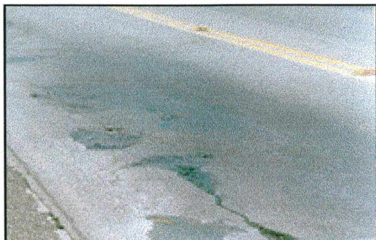
Fig. 8.1.3.1.- Detalhe Defeito na Superfície do Pavimento, c/Bombeamento de Finos
