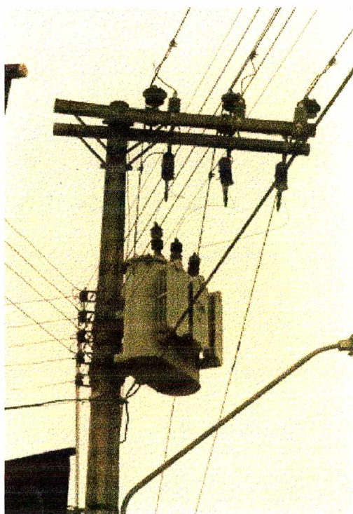
FIGURA 2.2: Transformador de Distribuição
