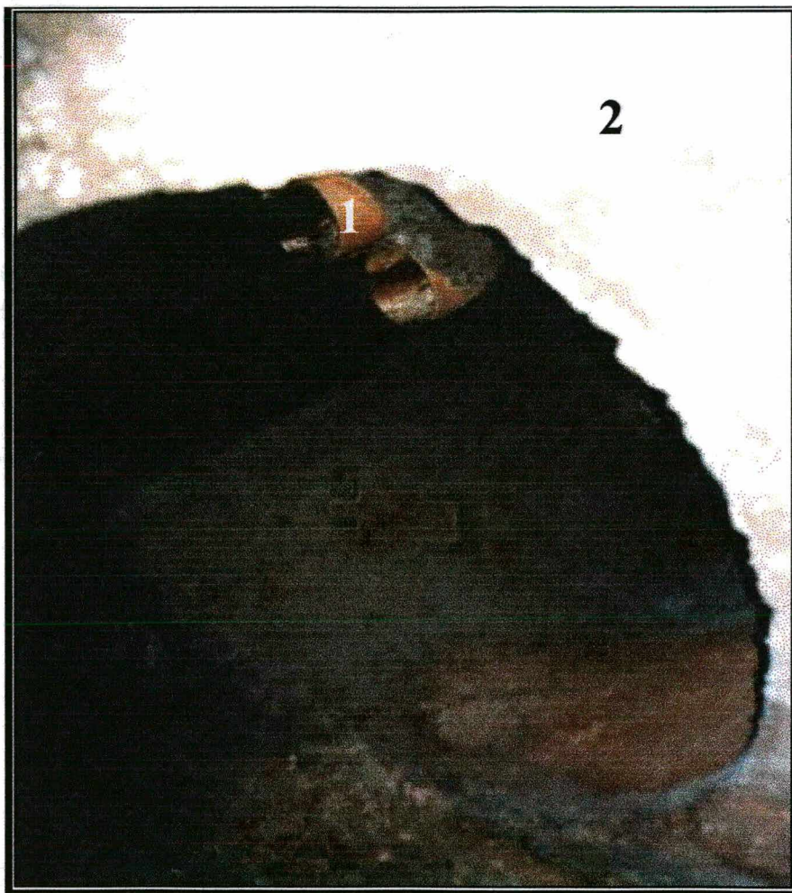
FOTO 9 – Ligação Clandestina à Galeria Pluvial.
