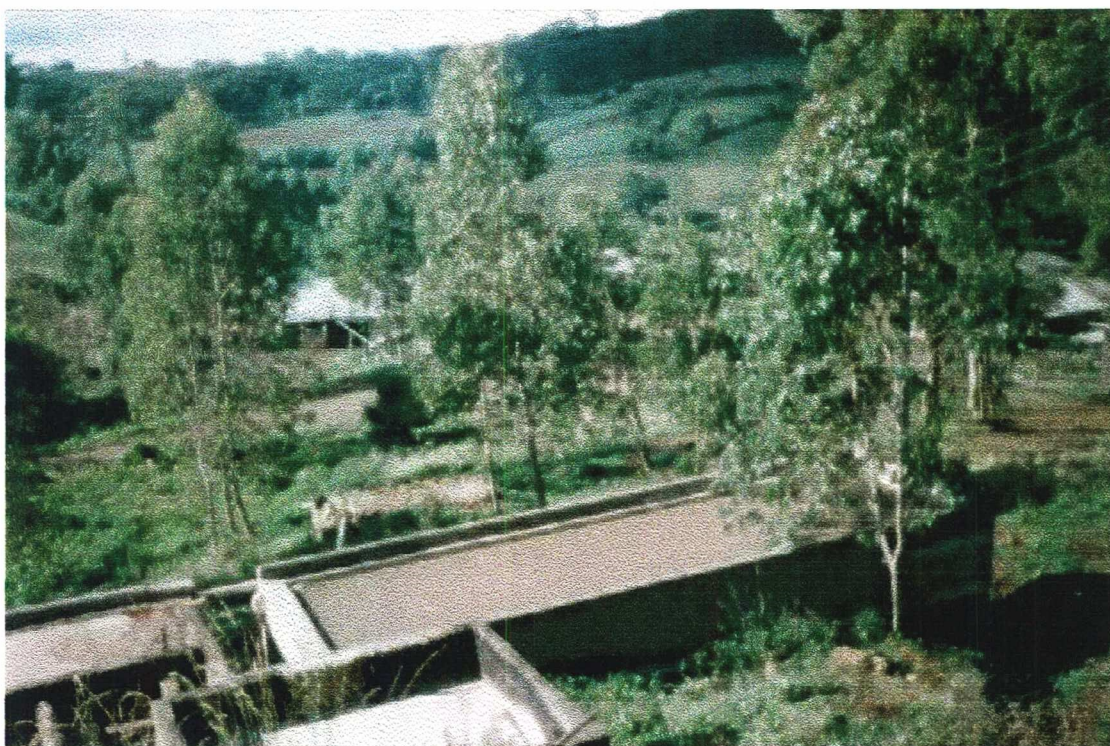
Fig. 4.02. Sistema de tratamento de efluentes instalado em solo íngreme. Problema: o efluente final não atende à legislação
