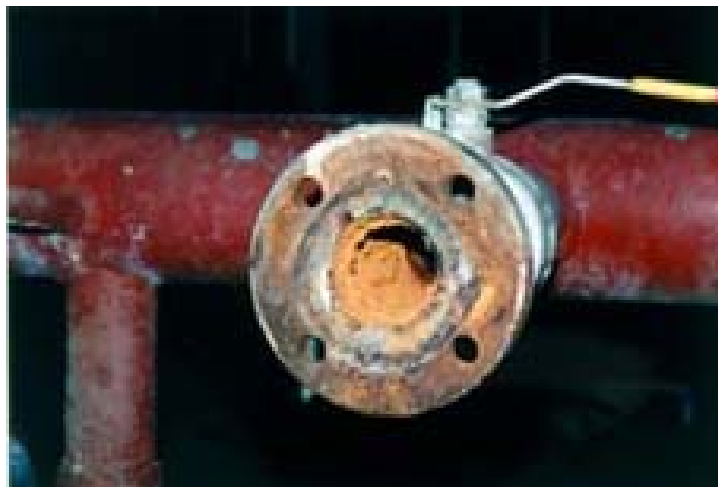
FIGURA 8 - Incrustação gerada pela presença de água com elevada dureza, [30].
