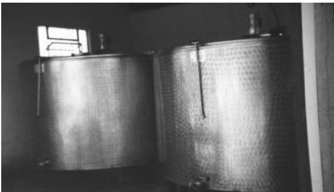
Figura 19: Tanque de expansão
