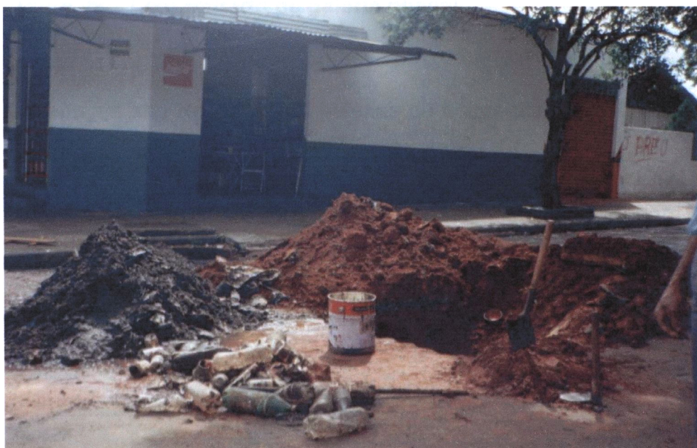
Fonte: Acervo da Prefeitura Municipal de Umuarama Figura 27 – Lixo retirado de galeria pluvial
