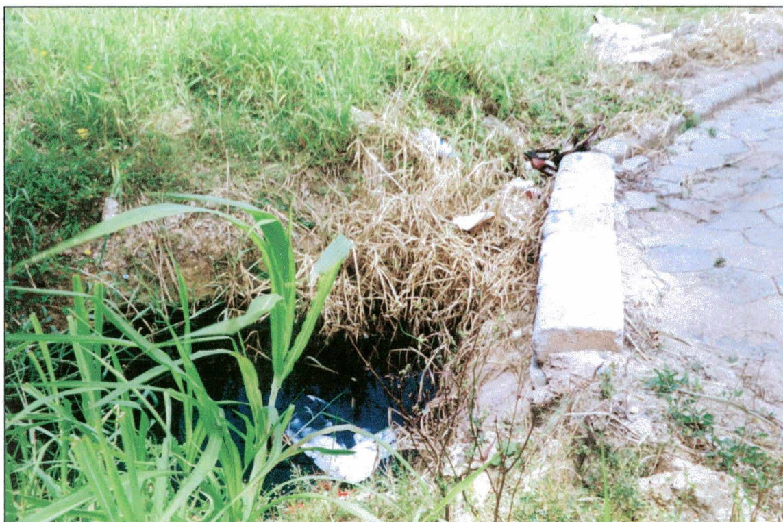
Figura ap.I.6 – Fotografia mostrando que o nível da água do mangue é bastante próximo do nível do loteamento. Ano: 2001.
