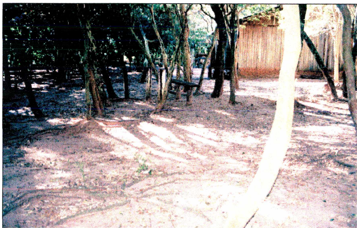
Vista parcial das árvores tendo como destaque as raízes expostas no solo, indicando a necessidade de ser feito aterro no local.
