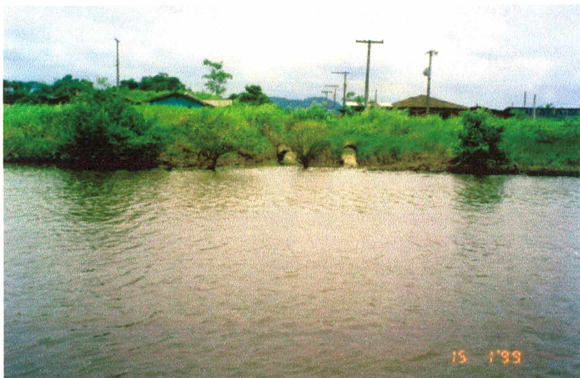
Foto 05: Bairro Espinheiros, Joinville, S.C: Tubulação da rede pluvial, que serve também para a saída do esgoto in natura , que é lançado diretamente no canal Varador, chegando na Lagoa Varador, Baía da Babitonga, S.C.
