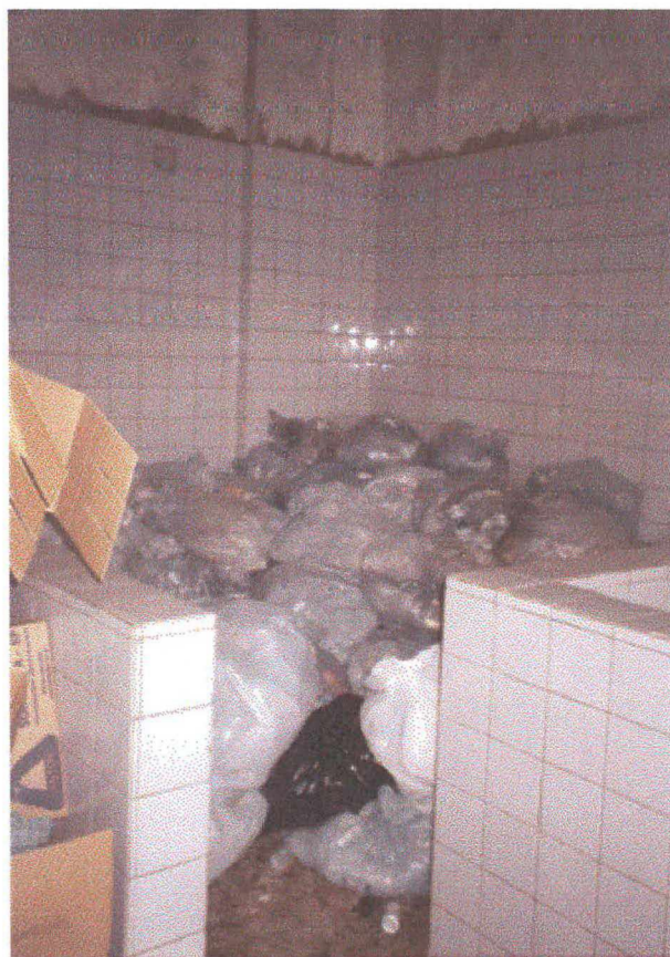
Figura 15: Repartição para armazenagem dos resíduos recicláveis no abrigo externo
