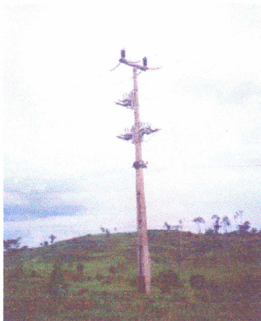
Figura 6.7-Capacitores e pára-raios tipo estação na derivação em Jarú
