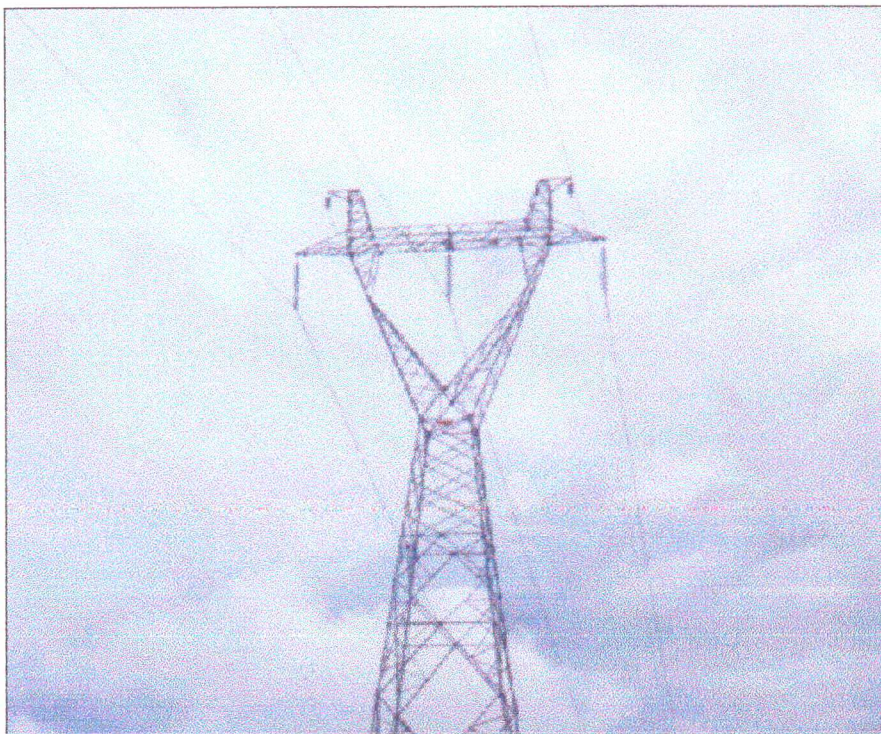
Figura 3.6- Torre de 230 kV com cabos pára-raios isolados
