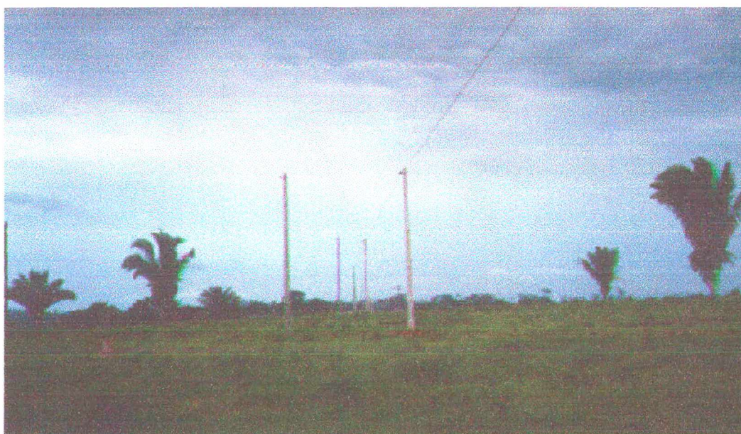
Figura 6.6- Eletrodo de terra nº 1, em Jaru
