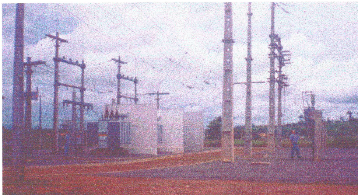
Figura 6.9- Estação distribuidora Jaru I
