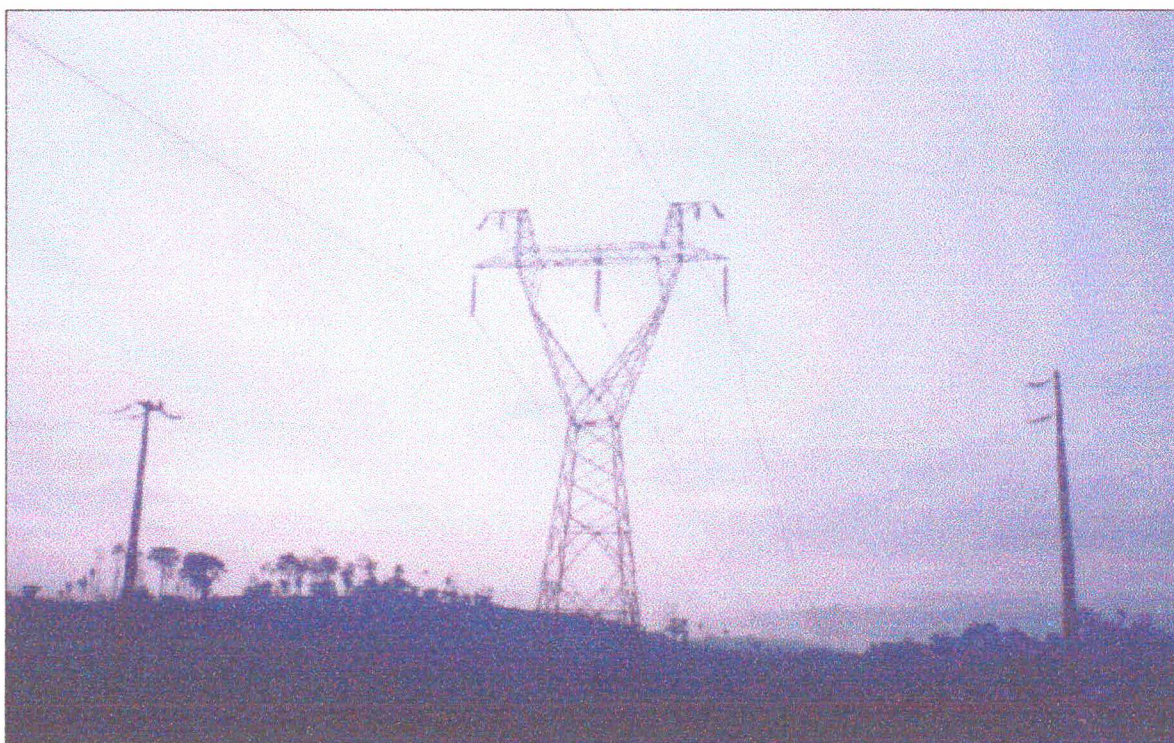
Figura 3.7- Torre contendo a derivação para a linha lateral do PRE
