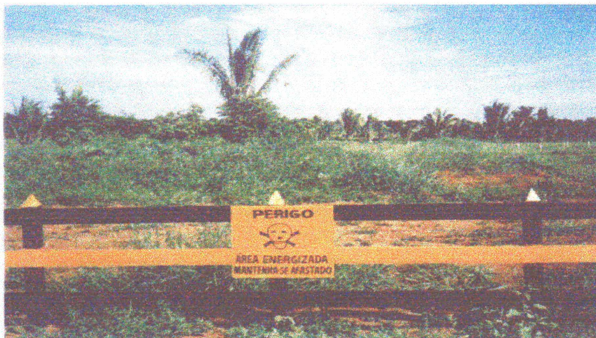
Figura 3.11- Cerca de proteção da malha independente - SE Ariquemes II
