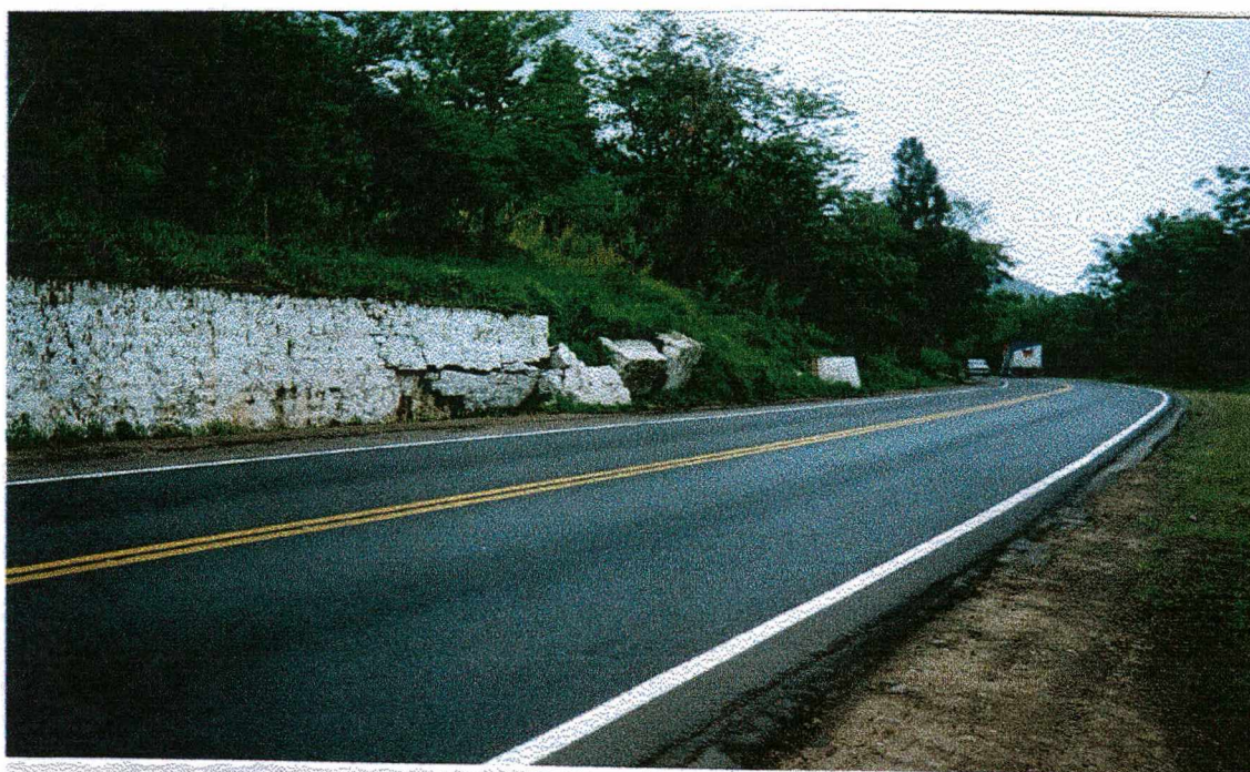
Figura V.5.1-IV: Escorregamento de Taludes Envolvendo Obras de Contenção
