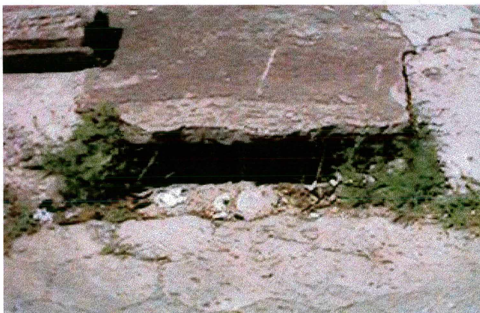
Figura 2.9 - Boca de lobo na esquina da Rua Hypólito Gregório Pereira com Dr. João de Oliveira. Observar o péssimo estado de conservação.
