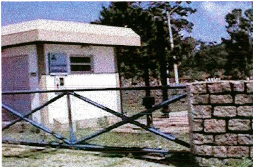
Figura 2.8 - Vista parcial da estação elevatória de esgotos EE-2, localizada no final da Av. Madre Maria Villac, próxima a barra do Rio Vargem do Brás.
