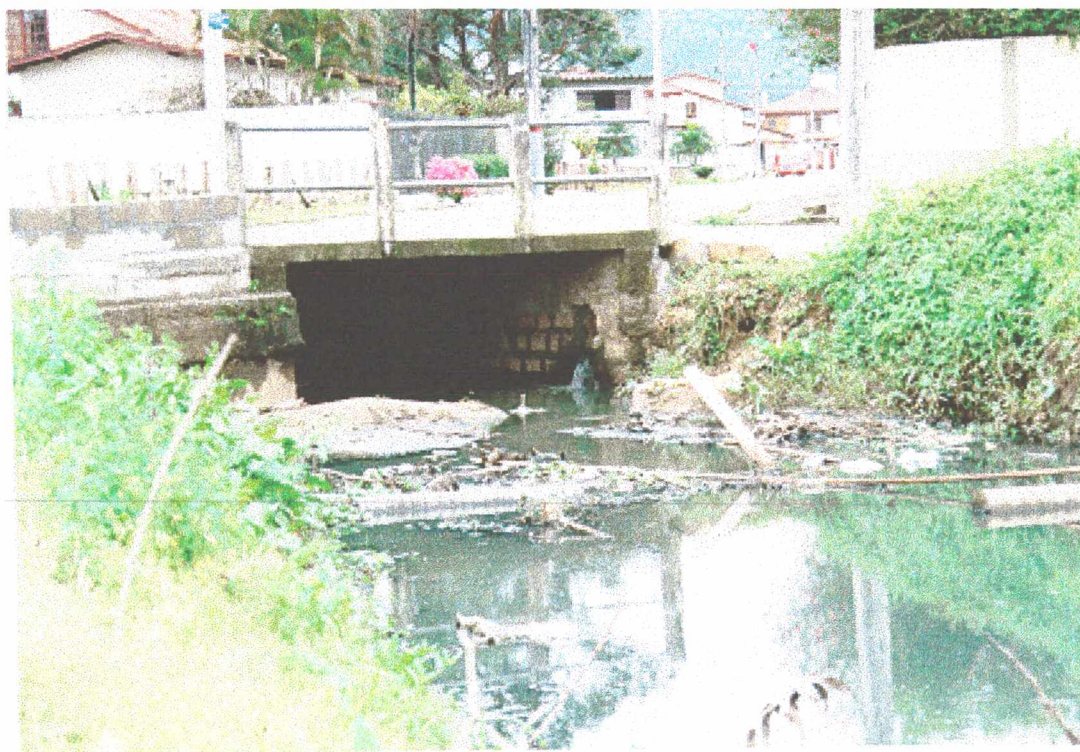
FIGURA 3 Acúmulo de detritos em canal principal de drenagem
