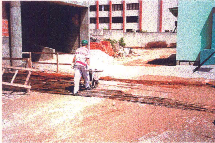
Foto 5.6 - Armazenagem dos vergalhões atrapalhando o fluxo das jericas
