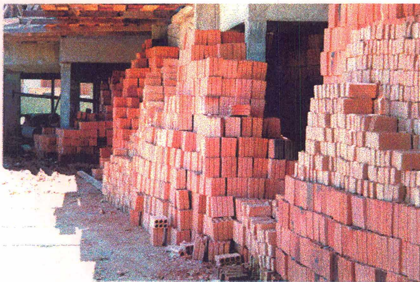
Foto 5.7 - Armazenamento excessivo de tijolos
