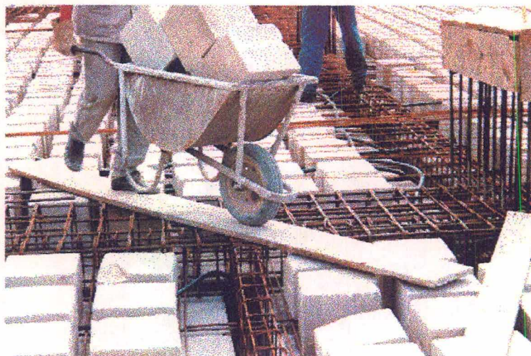
Foto 5.1 Uso de equipamento inadequado de transporte do material
