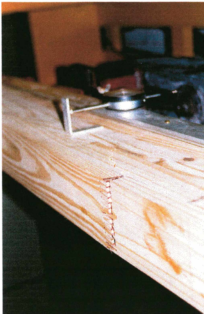
Foto 6.8 Ruptura de uma viga
