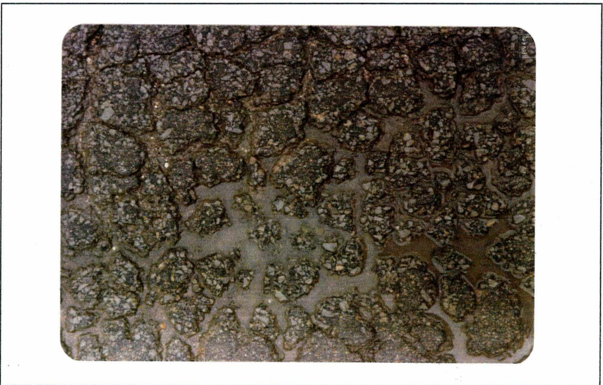
b) Pista de rolamento, detalhe do trincamento
