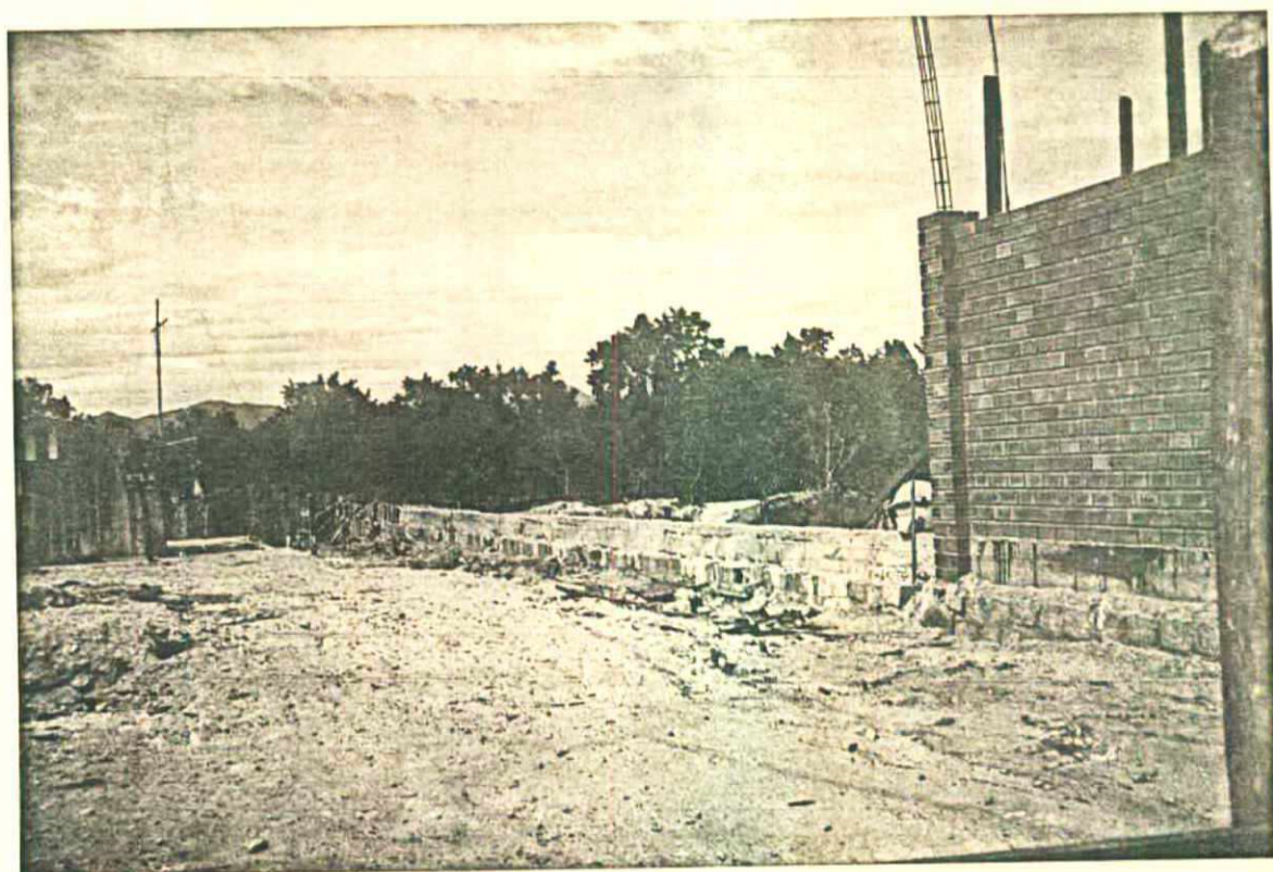
Foto 17 - Aterros e construções sobre o manguezal, nas proximidades da rodovia SC 405.
