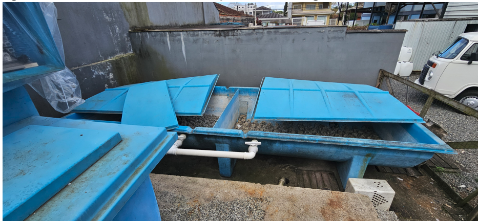
Figura 7 - Decantadores e tanques de secagem de lavanderia têxtil.
