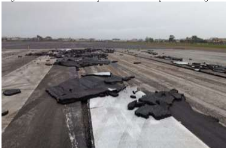
Figura 2.7 - Incidente com o pavimento no Aeroporto de Navegantes.
