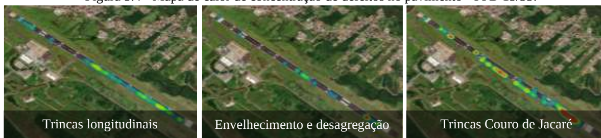
Figura 5.4 - Mapa de calor de concentração de defeitos no pavimento - PPD 15/33.
