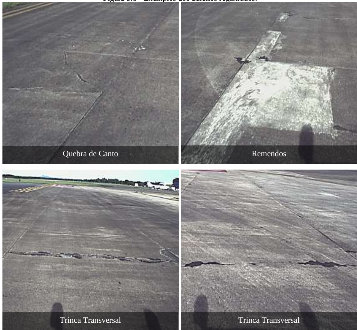
Figura 5.8 - Exemplos dos defeitos registrados.
