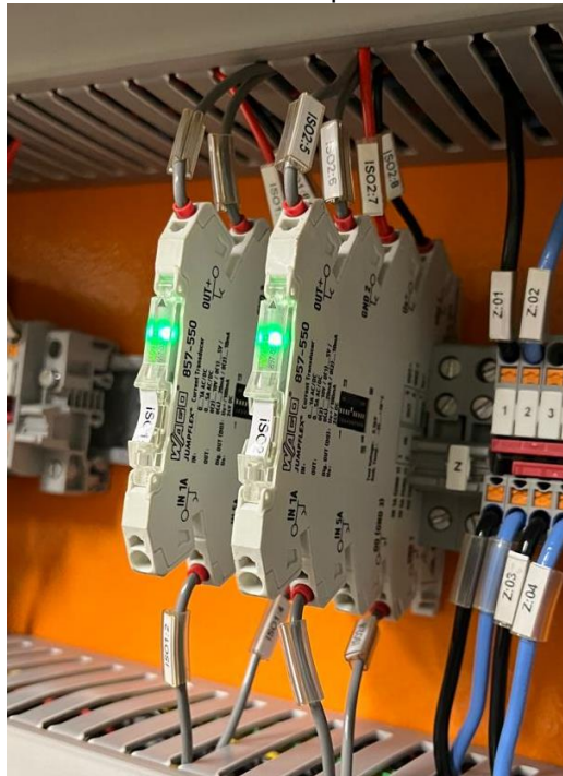
Figura 22 – Medidores de corrente de campo da bancada de ensaios
