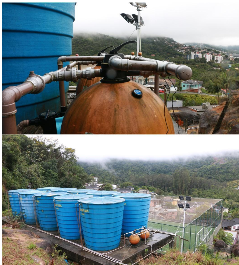
Figura 3 - Foto dos filtros e dos reservatórios da Barreira do Janga (VIEIRA, 2022).
