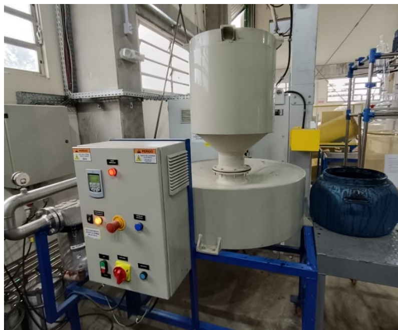
Figura 6 – Equipamento de filtração à vácuo.
