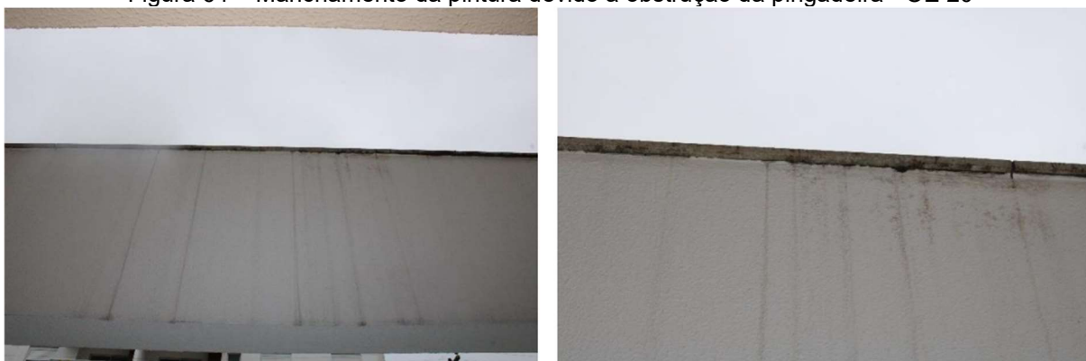
Figura 64 – Manchamento da pintura devido a obstrução da pingadeira - OE 20
