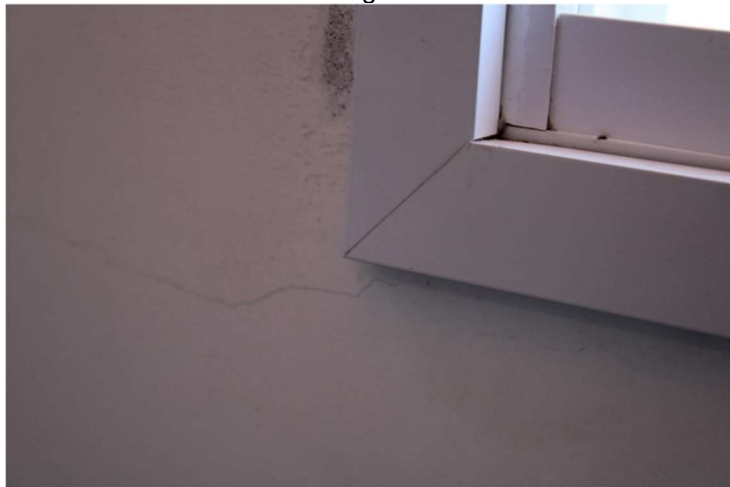
Figura 38 - Fissura geométrica por concentração de tensão devido a inexistência/ineficiência de contraverga - OE 15
