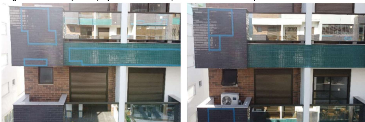
Figura 96 – Indicação de peça com som cavo por meio de ensaio de percussão na fachada – OE 21
