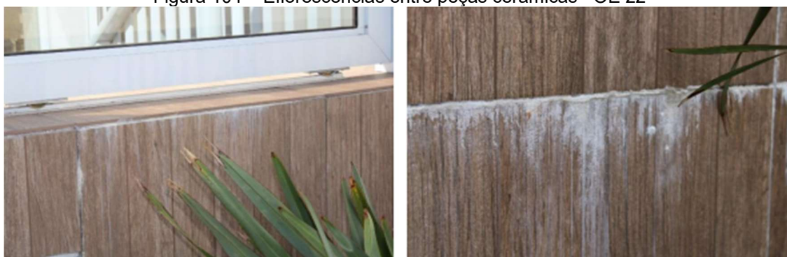
Figura 104 – Eflorescências entre peças cerâmicas– OE 22
