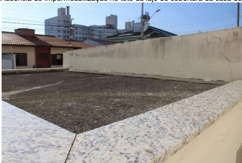
Figura 85 – Ausência de impermeabilização no teto da laje de cobertura da casa de gás - OE 02
