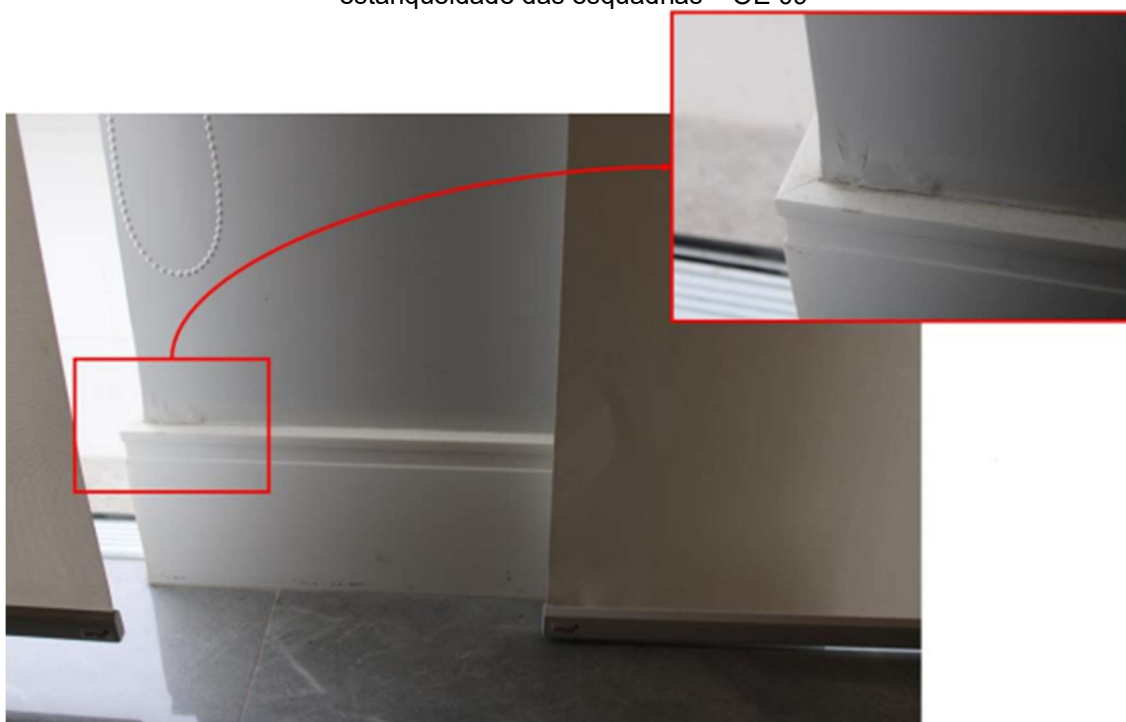
Figura 48 – Empolamentos e manchamentos da pintura por umidade devido a falhas de estanqueidade das esquadrias – OE 09
