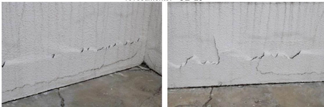
Figura 77 – Fissura geométrica decorrente a falha de amarração entre a manta asfáltica e revestimento. - OE 28
