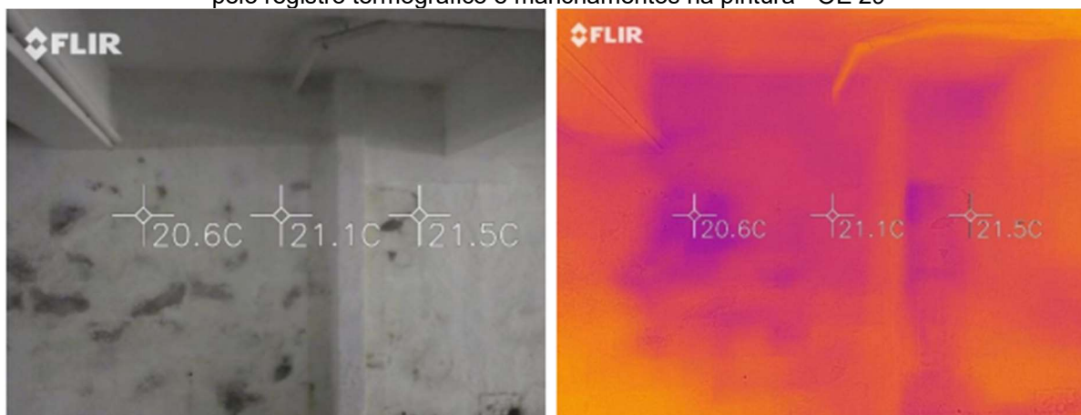
Figura 70 – Falhas de estanqueidade da impermeabilização da parede de contenção, evidenciada pelo registro termográfico e manchamentos na pintura - OE 29
