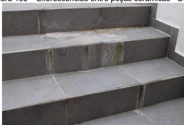
Figura 105 – Eflorescências entre peças cerâmicas– OE 28
