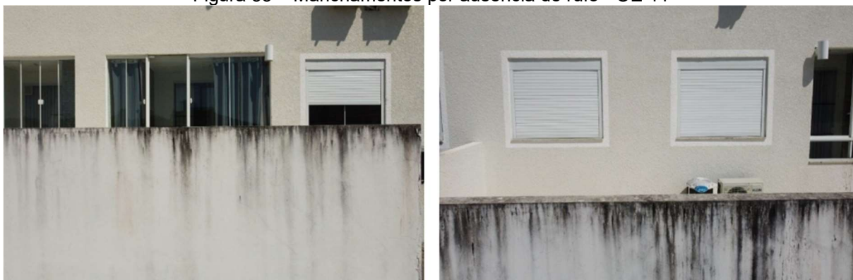
Figura 55 – Manchamentos por ausência de rufo - OE 11
