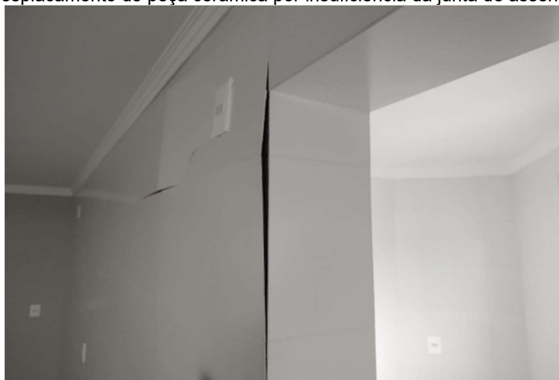
Figura 103 – Deslocamento de peça cerâmica por insuficiência da junta de assentamento– OE 16
