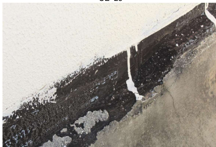
Figura 81 – Exposição da manta asfáltica devido a inexistência de camada de proteção mecânica. - OE 25
