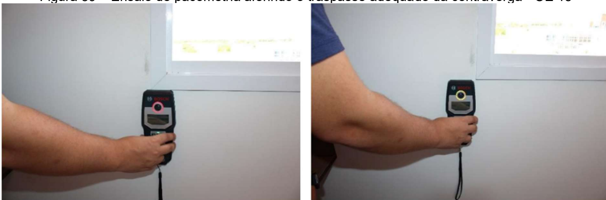
Figura 39 – Ensaio de pacometria aferindo o traspasse adequado da contraverga - OE 15
