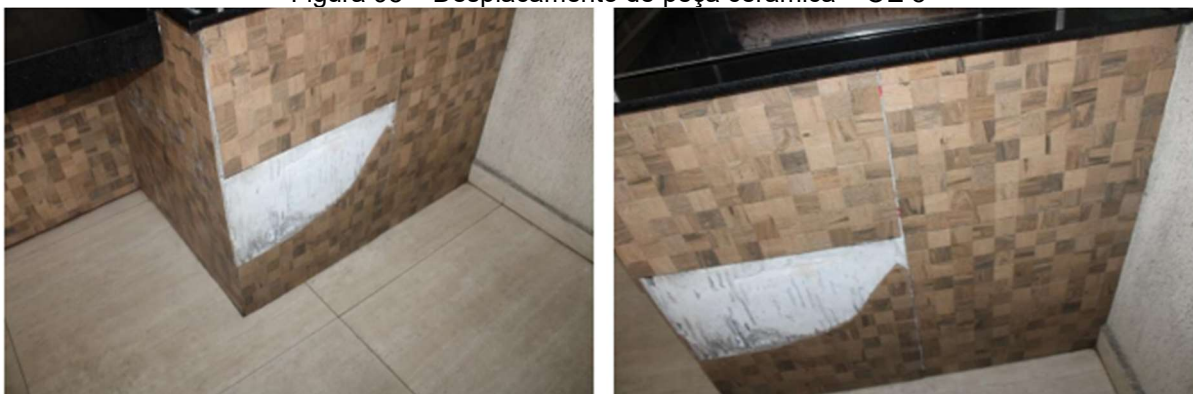
Figura 98 – Deslocamento de peça cerâmica – OE 8
