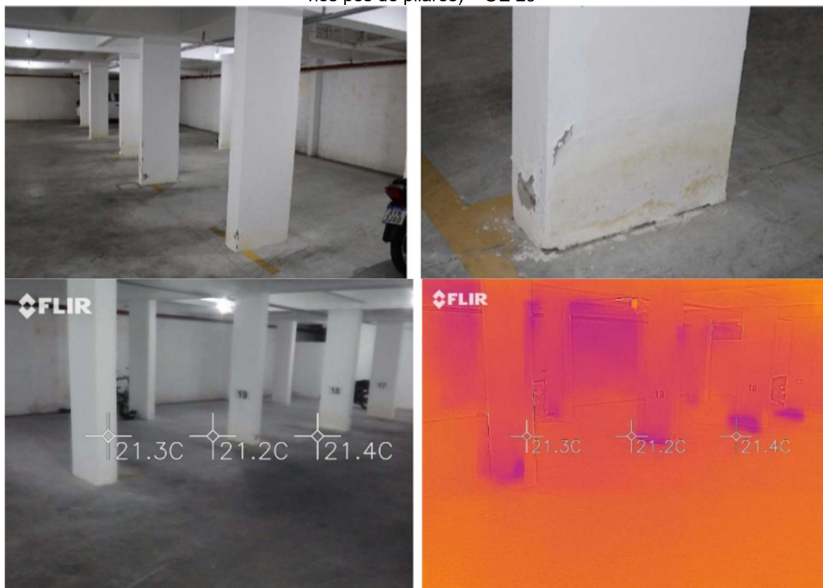
Figura 47 – Empolamentos e manchamentos da pintura por umidade devido a falhas de impermeabilização da viga baldrame (utilização da câmera termográfica para constatação da umidade nos pés de pilares) – OE 29
