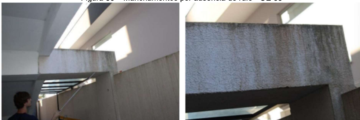
Figura 56 – Manchamentos por ausência de rufo - OE 33
