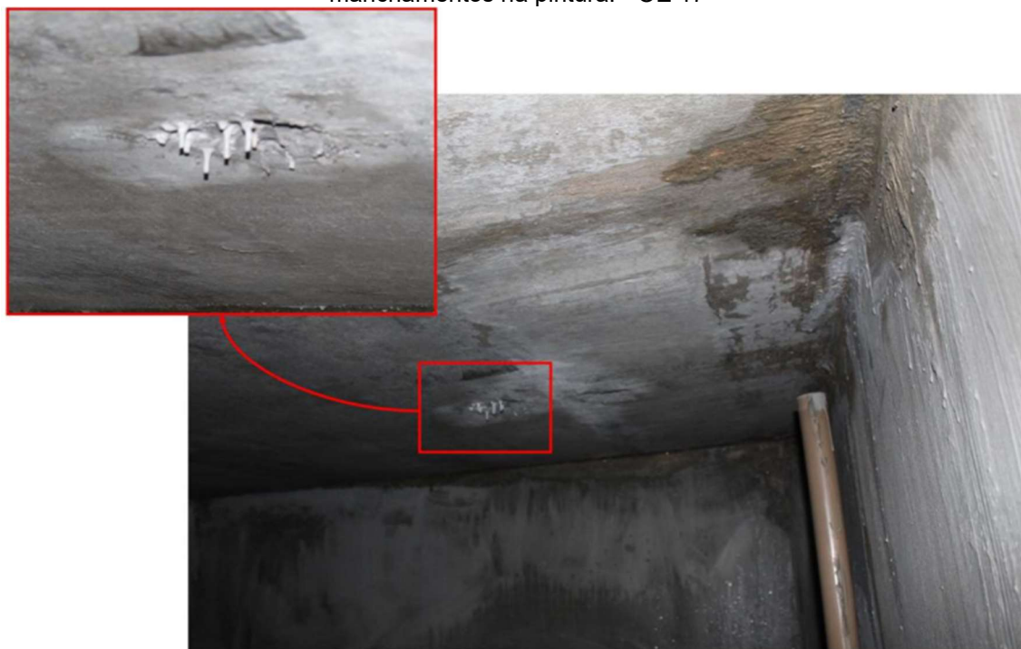
Figura 74 – Falhas de estanqueidade da impermeabilização de reservatório, evidenciada pelas estalactites (originadas pelo processo de lixiviação e carbonatação do hidróxido de cálcio) e manchamentos na pintura. - OE 17
