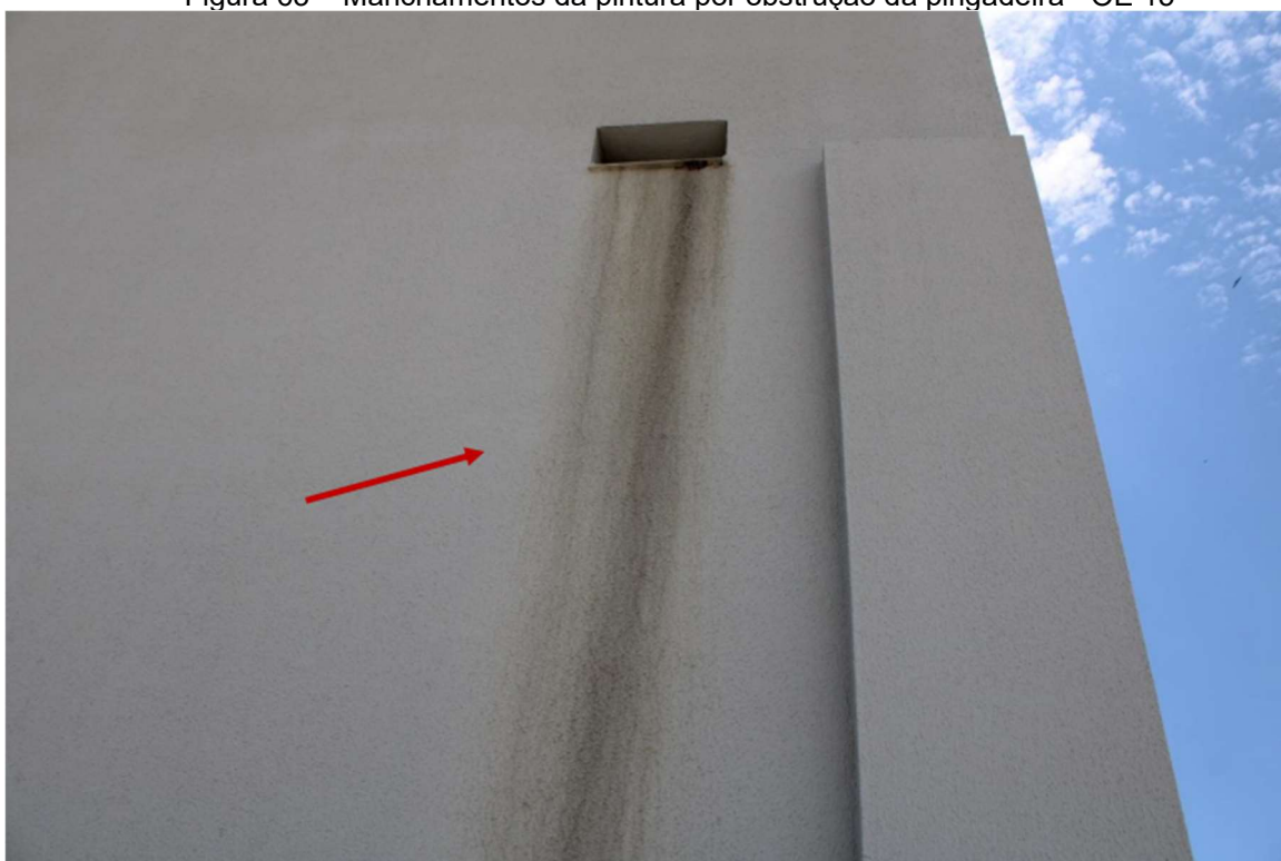
Figura 63 – Manchamentos da pintura por obstrução da pingadeira - OE 15
