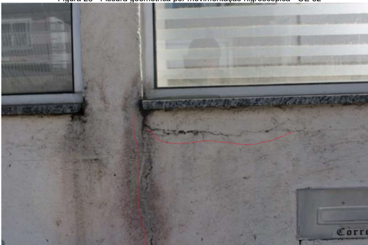
Figura 28 - Fissura geométrica por movimentação higroscópica - OE 32
