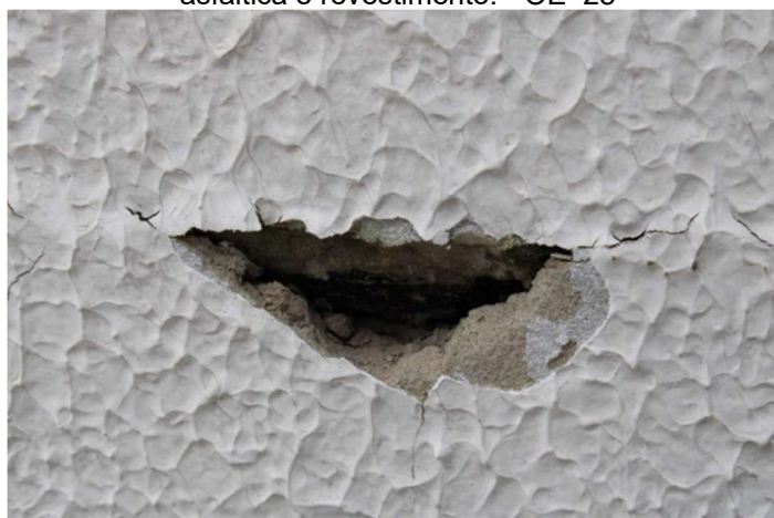
Figura 78 – Abertura de janela de inspeção para constatar a ausência de amarração entre manta asfáltica e revestimento. - OE 28
