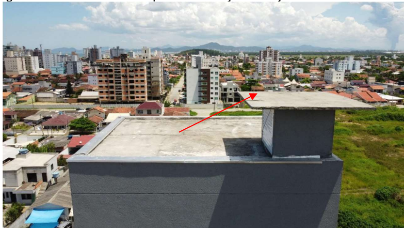
Figura 87 – Ausência de impermeabilização na laje de cobertura - OE 04
