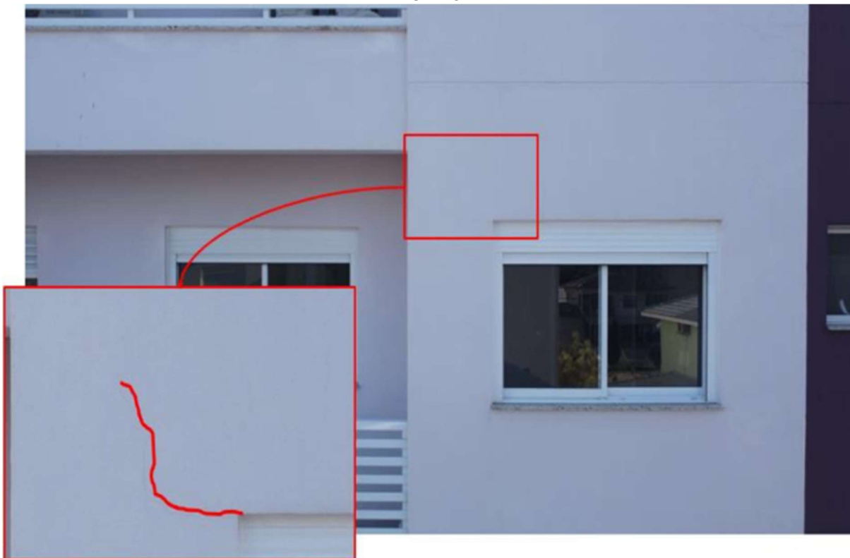
Figura 34 - Fissura geométrica por concentração de tensão devido a inexistência/ineficiência de verga - OE 13
