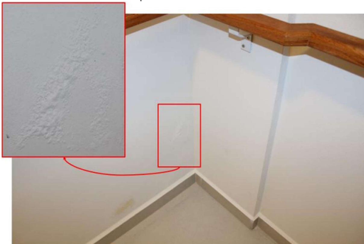
Figura 49 – Empolamentos e manchamentos da pintura por umidade devido a falhas de estanqueidade das fachadas– OE 09
