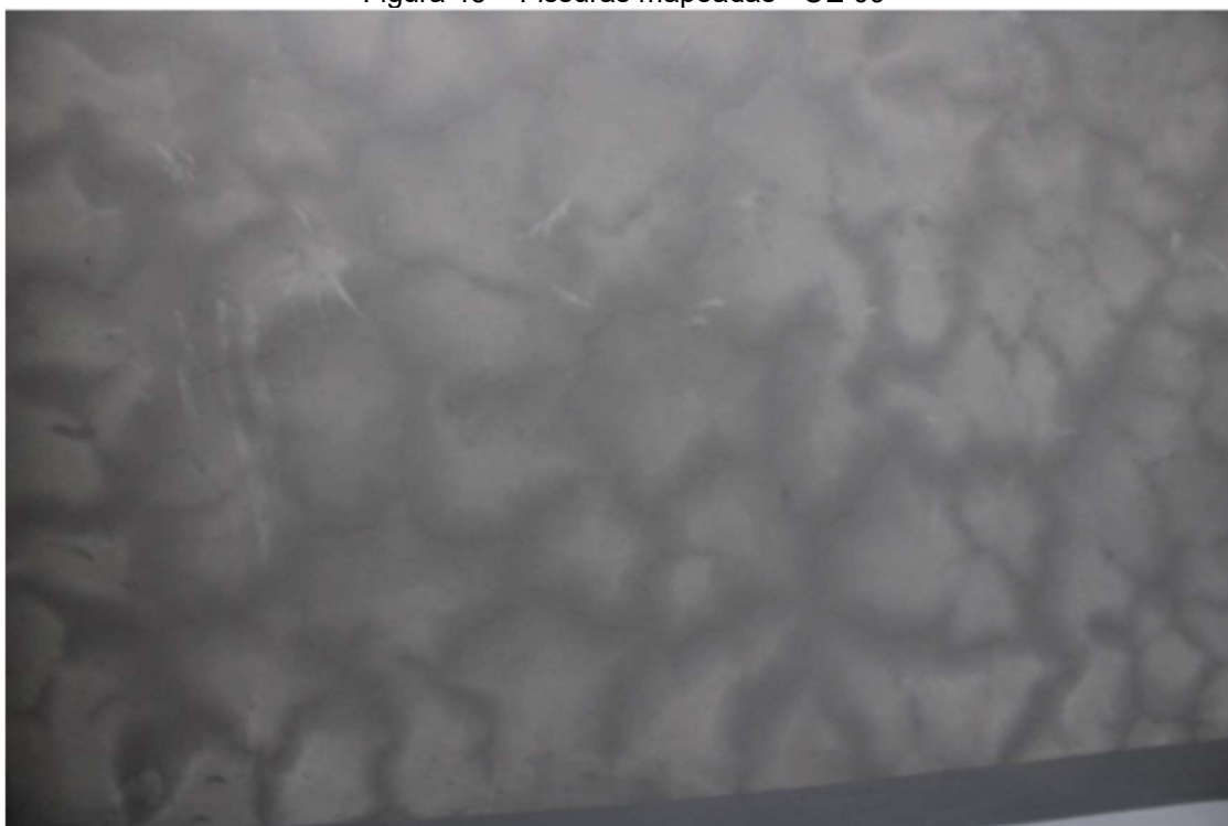
Figura 43 – Fissuras mapeadas - OE 09
