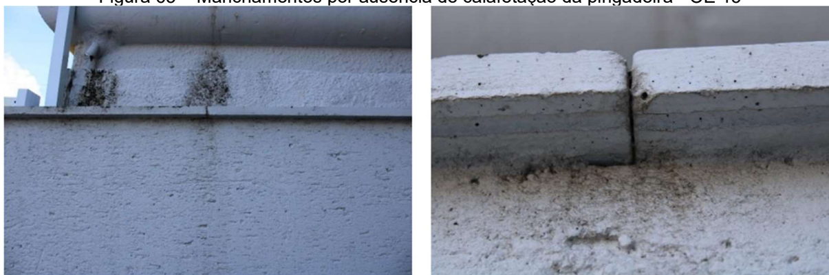
Figura 65 – Manchamentos por ausência de calafetação da pingadeira - OE 15
