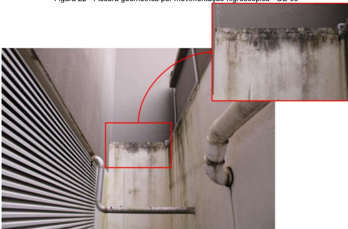
Figura 22 - Fissura geométrica por movimentação higroscópica - OE 09
