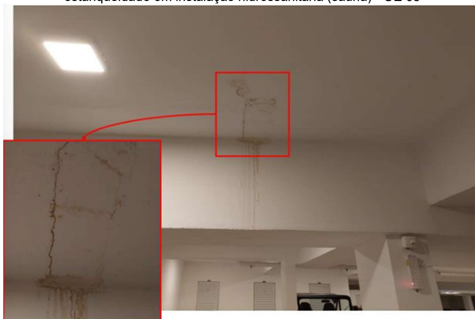
Figura 52 – Empolamentos e manchamentos da pintura por umidade devido a falhas de estanqueidade em instalação hidrossanitária (sauna) - OE 05
