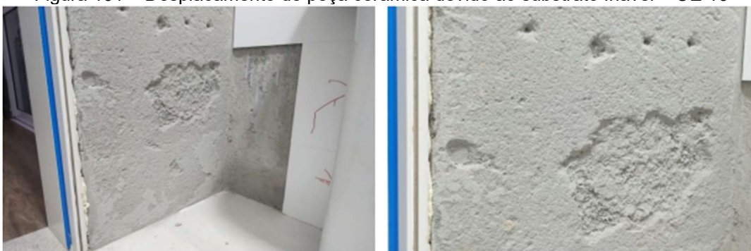
Figura 101 – Deslocamento de peça cerâmica devido ao substrato friável – OE 16
