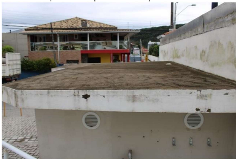
Figura 86 – Ausência de impermeabilização no teto da laje de cobertura da casa de gás - OE 29
