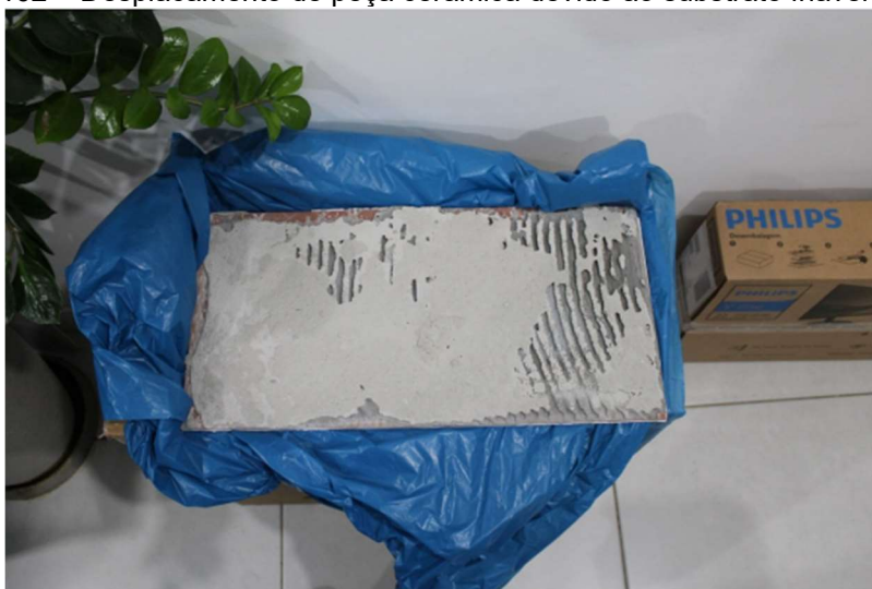
Figura 102 – Deslocamento de peça cerâmica devido ao substrato friável – OE 16
