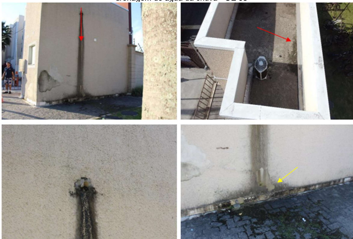
Figura 54 – Empolamentos (seta amarela) e biodeterioração da pintura por umidade devido a erros na drenagem de água da chuva - OE 08
