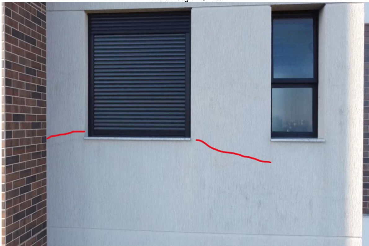
Figura 35 - Fissura geométrica por concentração de tensão devido a inexistência/ineficiência de contra-verga - OE 17
