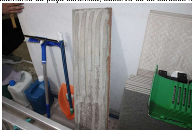
Figura 99 – Deslocamento de peça cerâmica, observa-se os cordões não rompidos – OE 8
