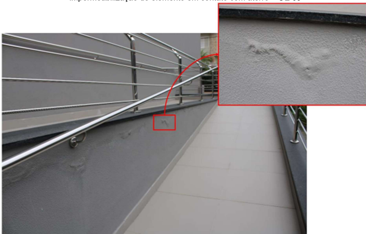
Figura 46 – Empolamentos e manchamentos da pintura por umidade devido a falhas na impermeabilização do elemento em contato com aterro – OE 09
