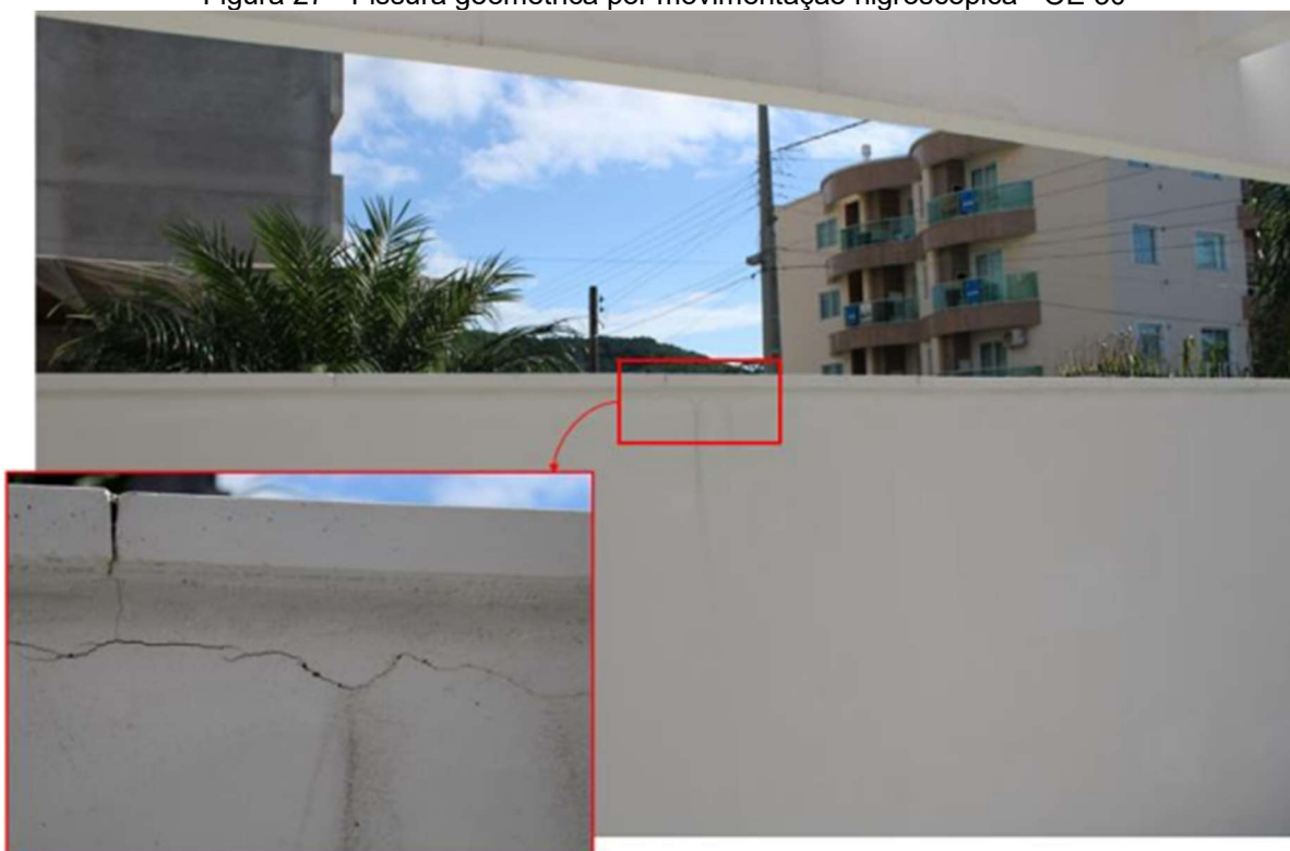
Figura 27 - Fissura geométrica por movimentação higroscópica - OE 30
