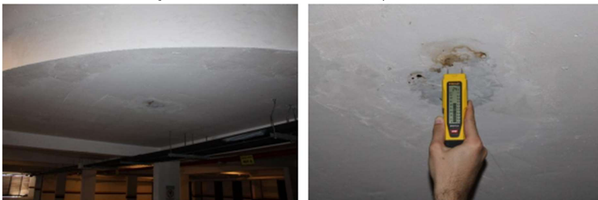
Figura 71 – Falhas de estanqueidade da impermeabilização em laje descoberta, evidenciada pela medição de umidade e manchamentos na pintura. - OE 21
