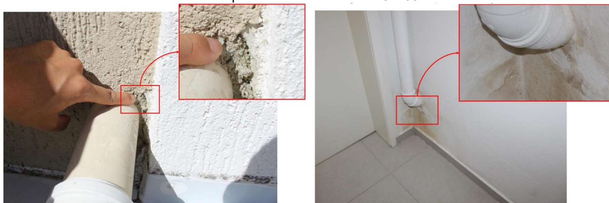
Figura 51 – Empolamentos e manchamentos da pintura por umidade devido a falhas de estanqueidade das fachadas– OE 09
