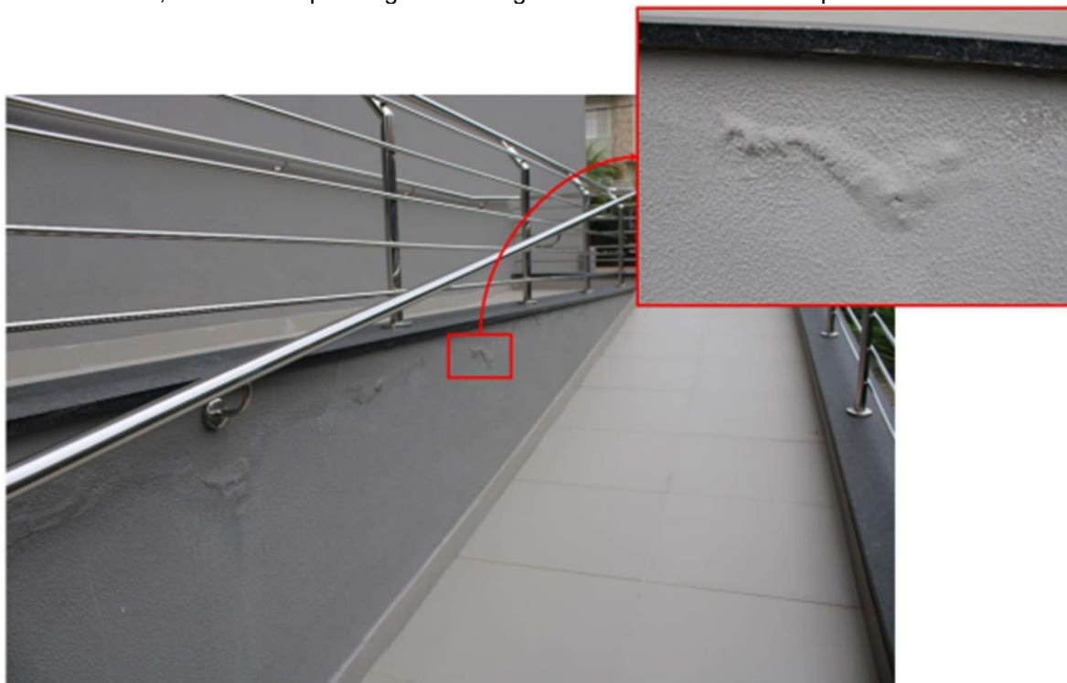
Figura 72 – Falhas de estanqueidade da impermeabilização da rampa de acesso em contato com o terreno, evidenciada pelo registro termográfico e manchamentos na pintura - OE 09
