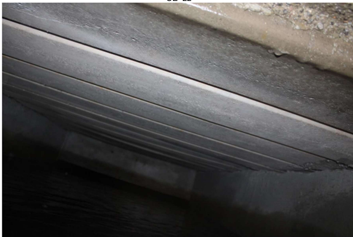
Figura 89 – Ausência de impermeabilização no fundo da laje de cobertura do reservatório superior - OE 22
