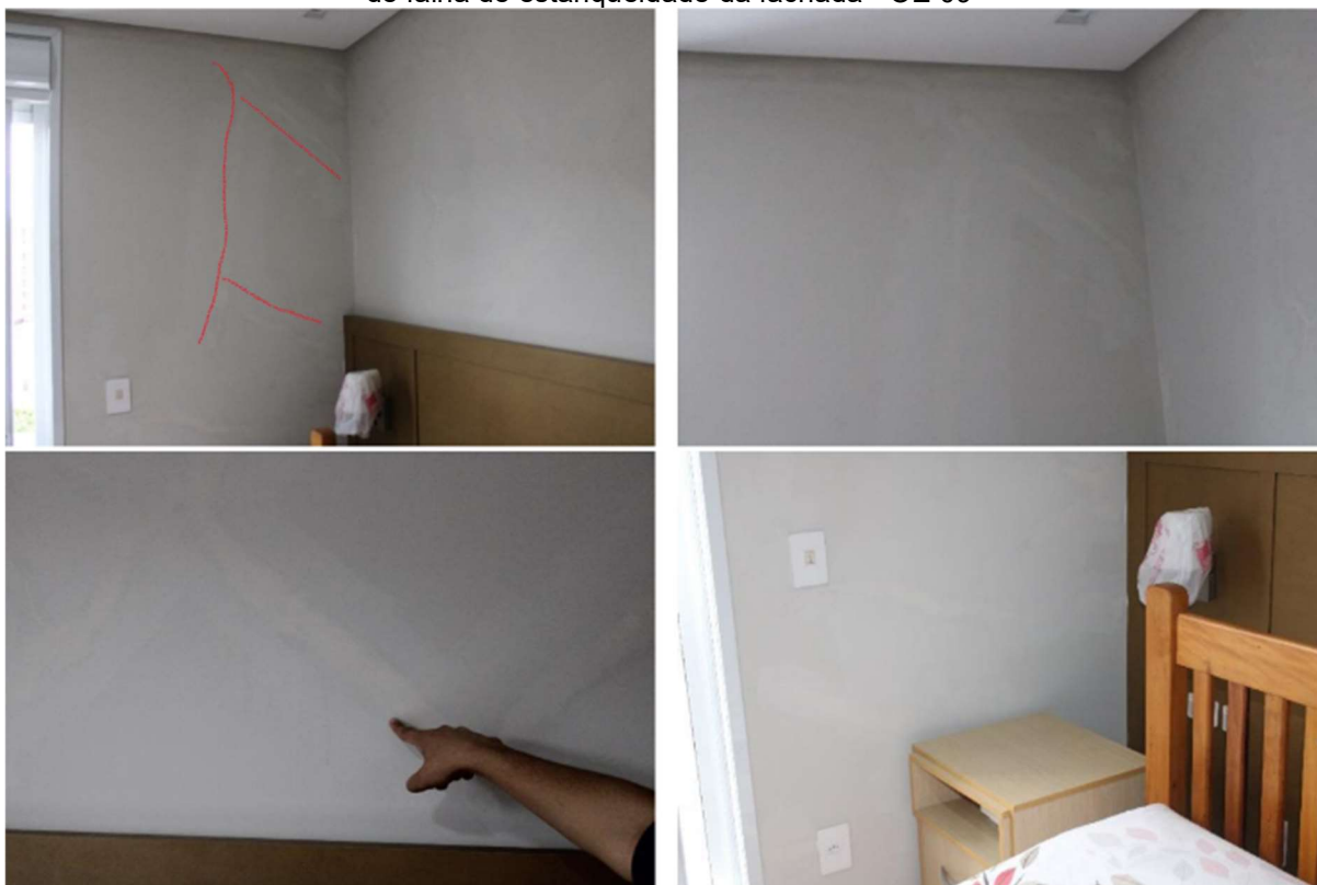
Figura 24 - Fissura geométrica por movimentação higroscópica reparadas pela construtora advindas de falha de estanqueidade da fachada - OE 09
