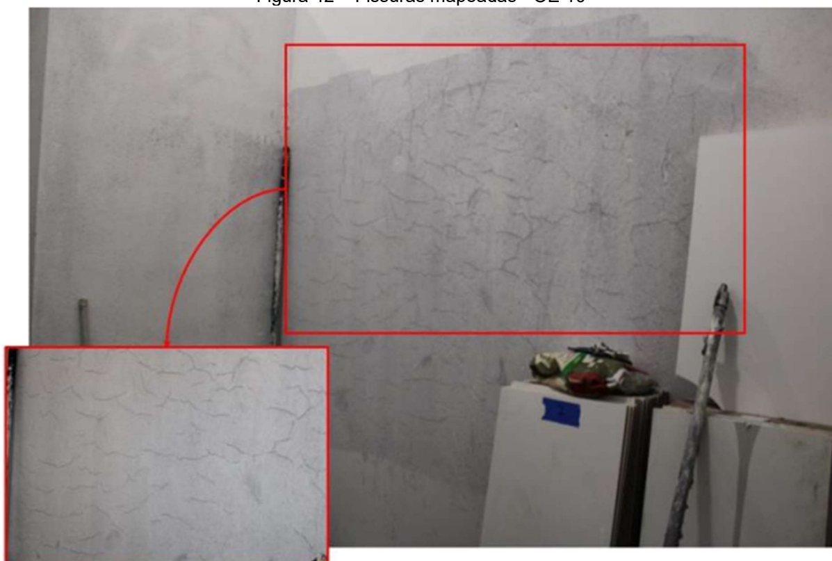
Figura 42 – Fissuras mapeadas - OE 10
