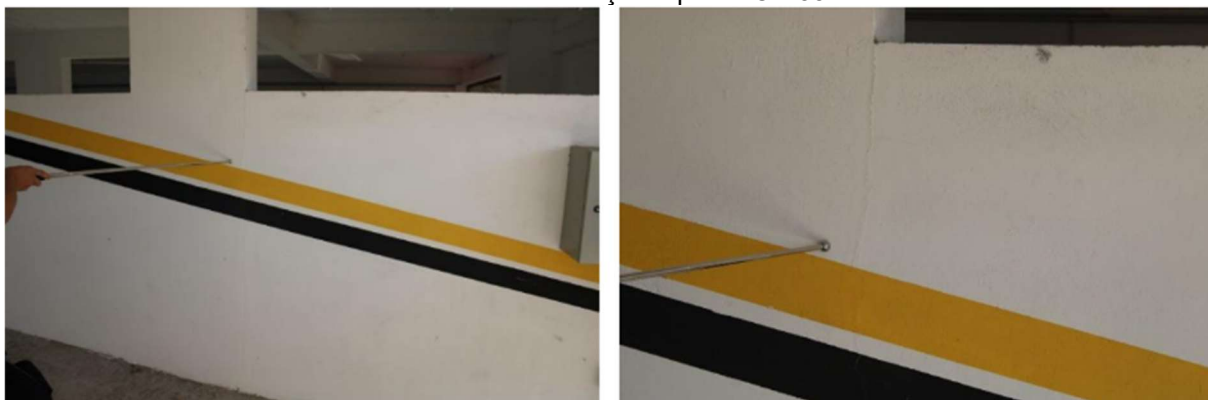
Figura 20 - Fissura geométrica vertical por movimentação diferencial entre alvenaria de vedação e pilar - OE 33
