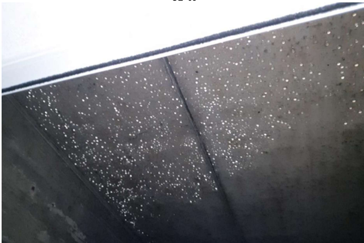
Figura 88 – Ausência de impermeabilização no fundo da laje de cobertura do reservatório superior - OE 05
