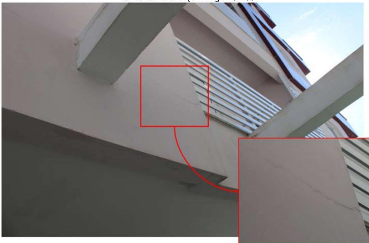
Figura 21 - Fissura geométrica horizontal por movimentação diferencial entre alvenaria de vedação e viga - OE 30
