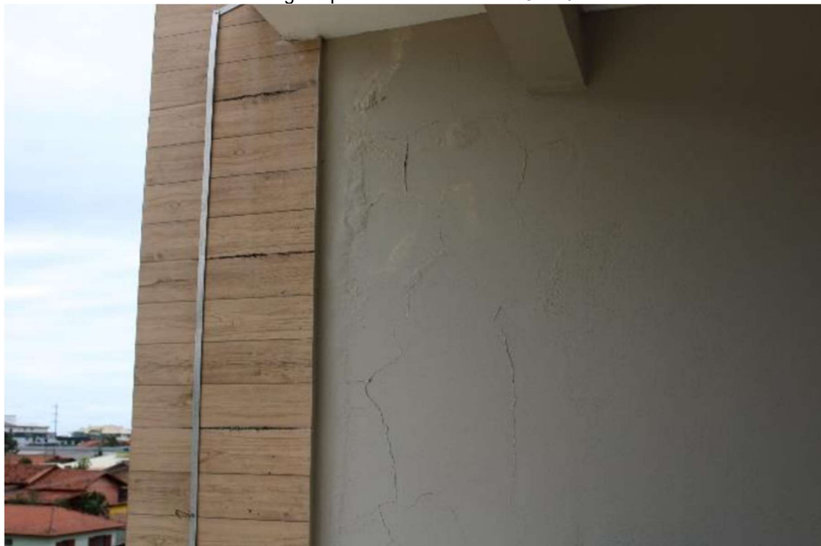
Figura 23 - Fissura geométrica por movimentação higroscópica devido a falhas no sistema drenante de águas pluviais na cobertura - OE 29
