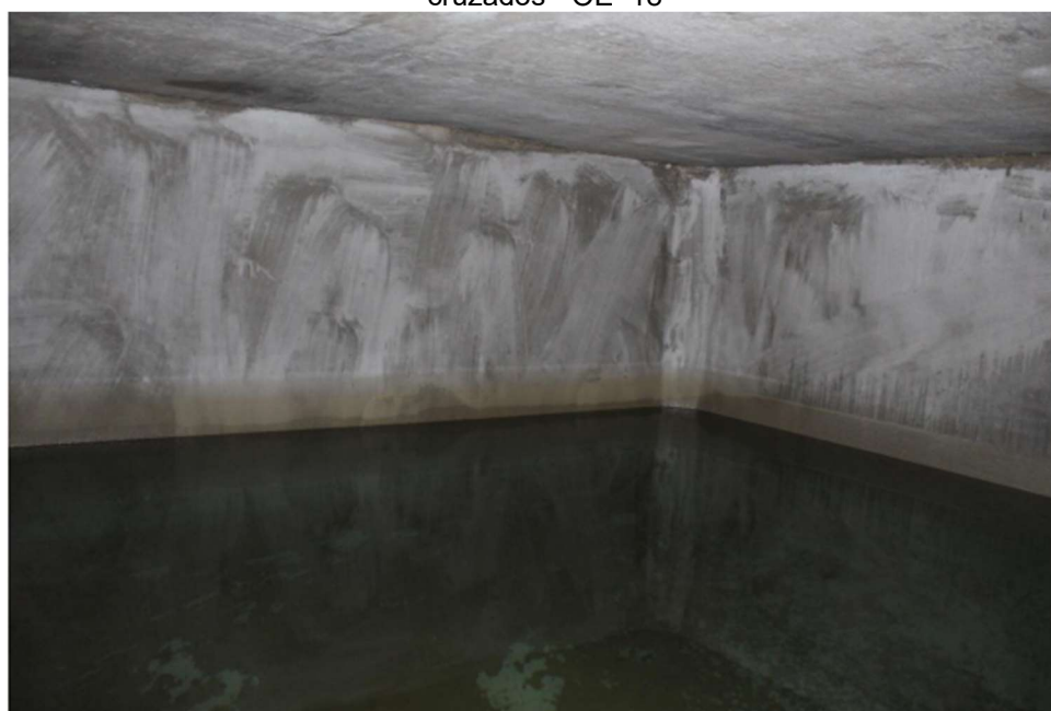
Figura 83 – Demãos da impermeabilização do reservatório superior distribuídas aleatoriamente. O item 4.2.3.2 da norma ABNT NBR 9574:2008 estabelece que as demãos devem ser em sentidos cruzados - OE 18
