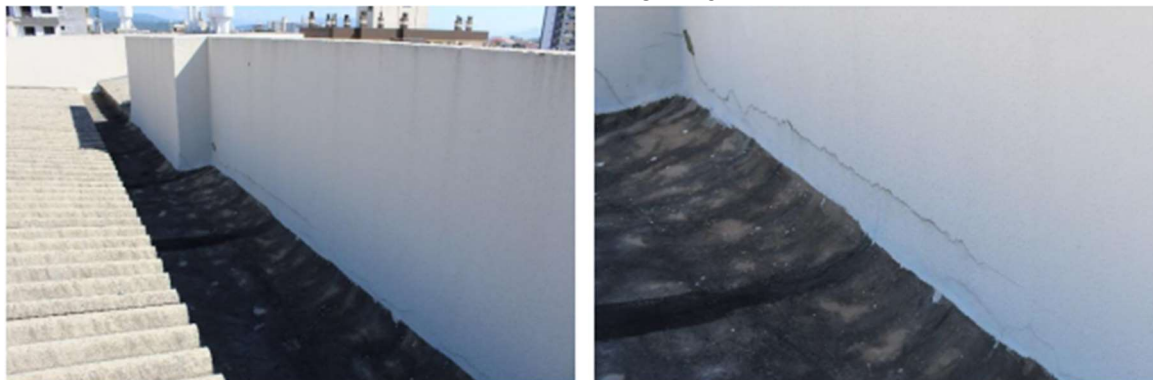
Figura 79 – Fissura geométrica decorrente a falha de amarração entre a manta asfáltica e revestimento. - OE 18
