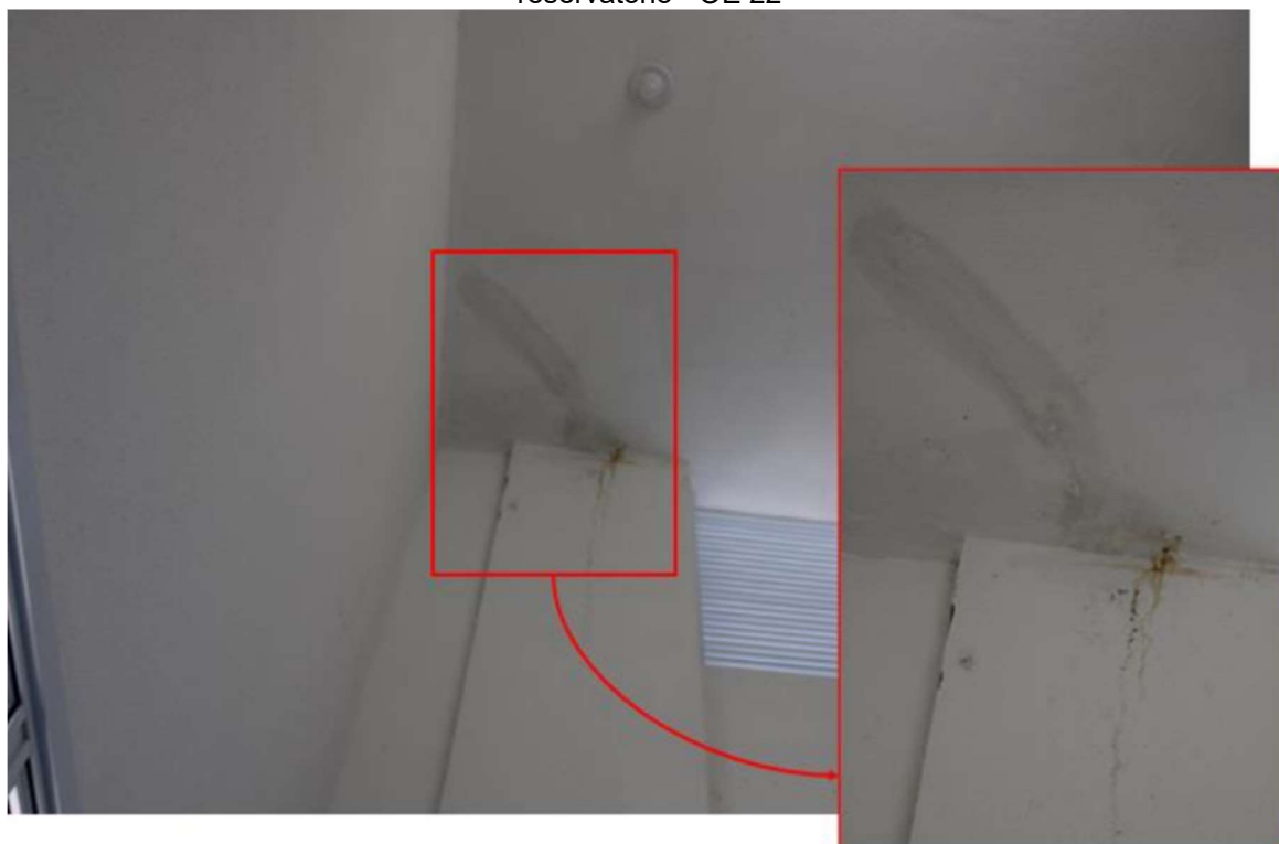
Figura 30 - Fissura geométrica por movimentação higroscópica devido a falhas de estanqueidade de reservatório - OE 22
