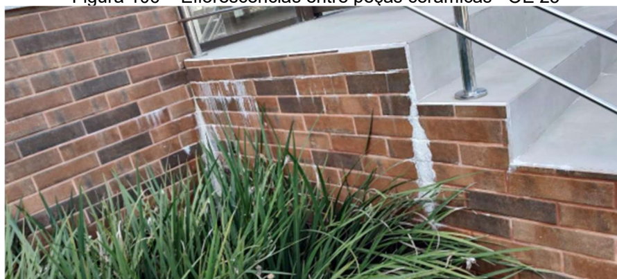
Figura 106 – Eflorescências entre peças cerâmicas– OE 25
