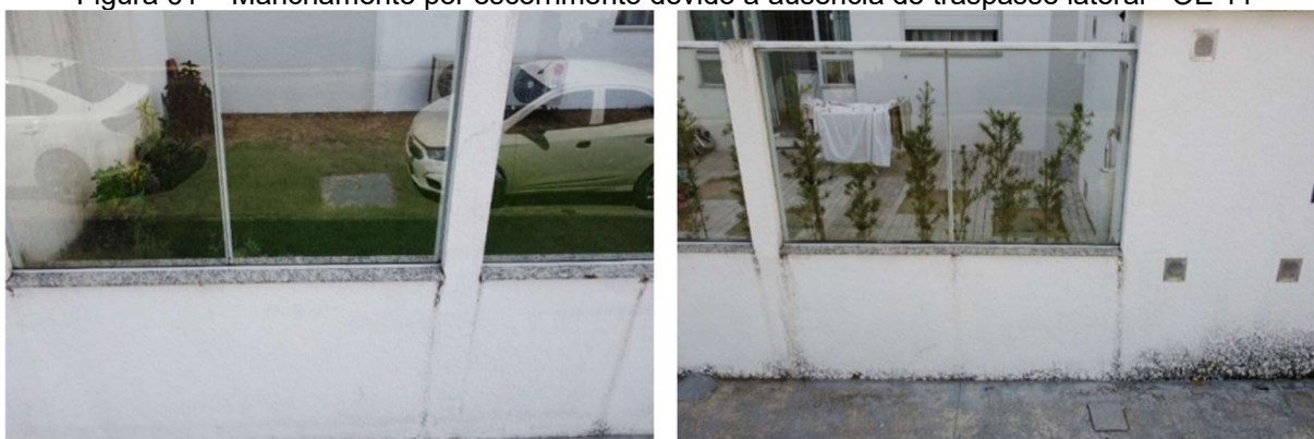
Figura 61 – Manchamento por escoamento devido à ausência de traspasse lateral - OE 11
