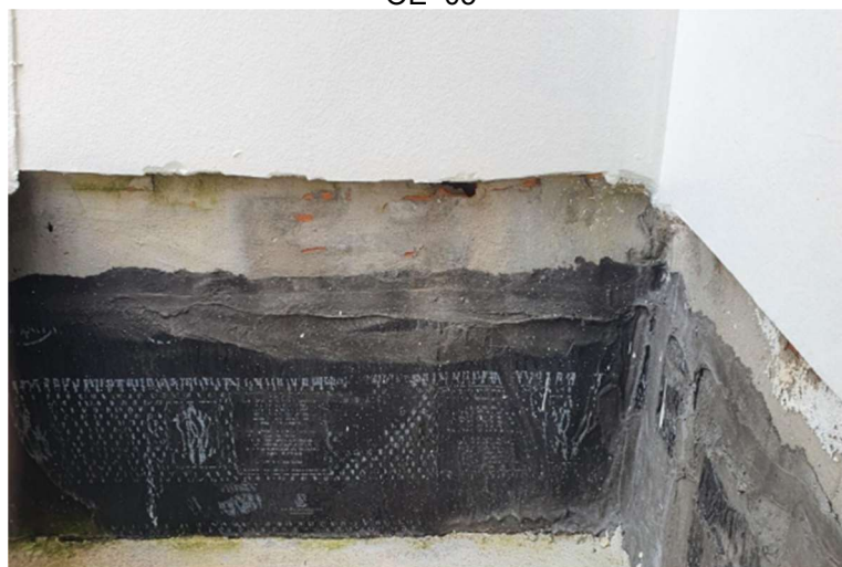
Figura 80 – Exposição da manta asfáltica devido a inexistência de camada de proteção mecânica. - OE 05
