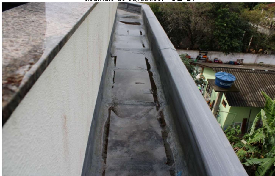
Figura 76 – Falhas de caimento da impermeabilização, evidenciada empoçamento de água e acúmulo de sujidades. - OE 24
