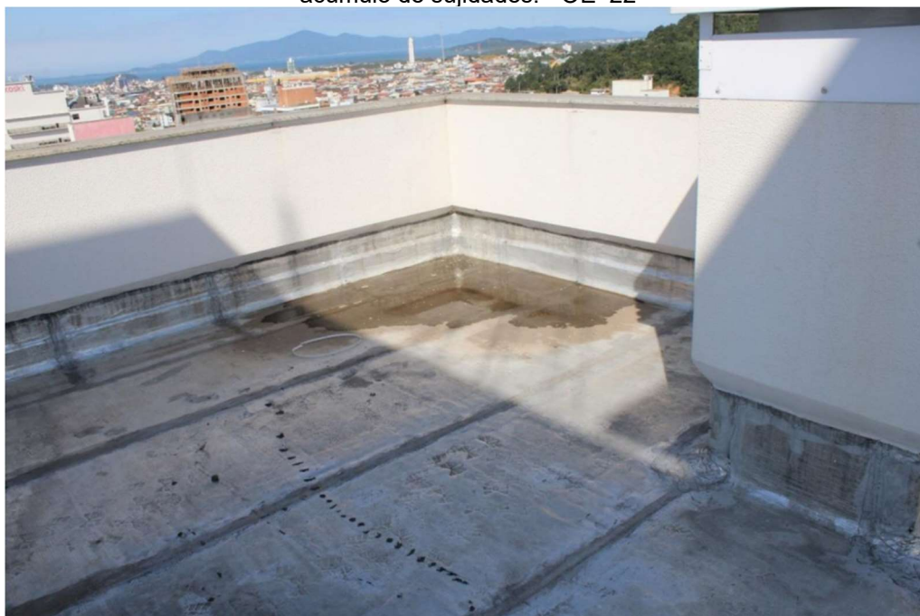
Figura 75 – Falhas de caimento da impermeabilização, evidenciada empoçamento de água e acúmulo de sujidades. - OE 22
