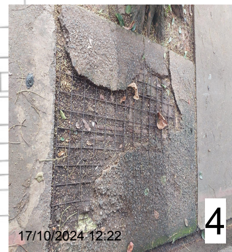
Figura 10 - Desnível na calçada
