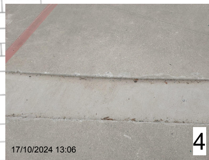
Figura 36 - Desnível na calçada
