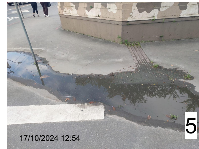
Figura 22 - Rebaixo com água parada
