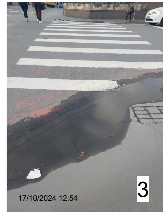
Figura 25 - Rebaixo com água parada
