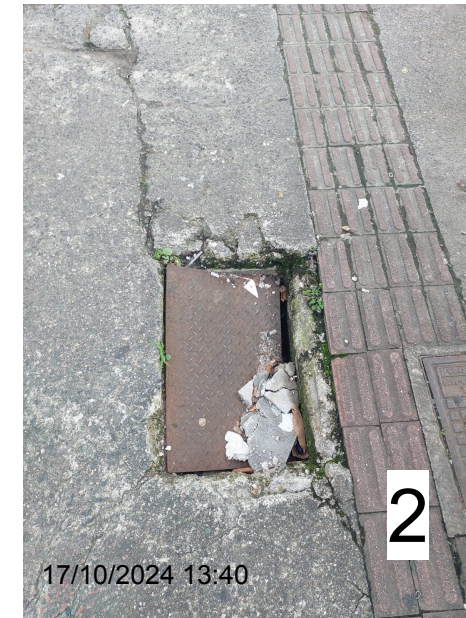
Figura 61 - Desnível na calçada
