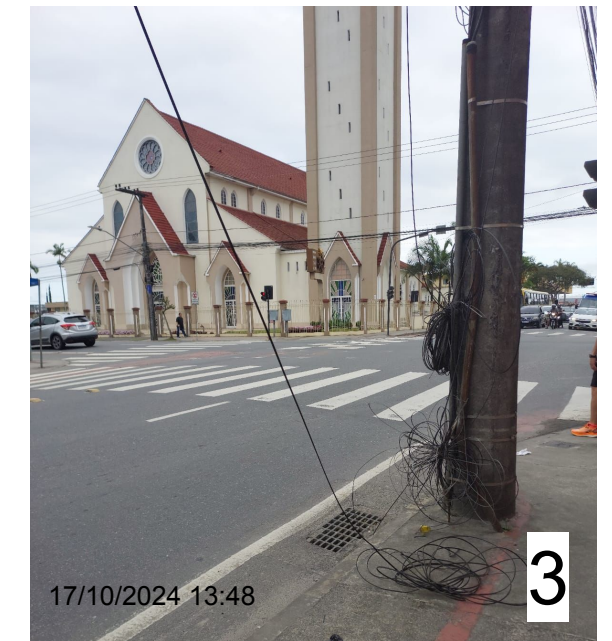
Figura 67 - Fios na calçada
