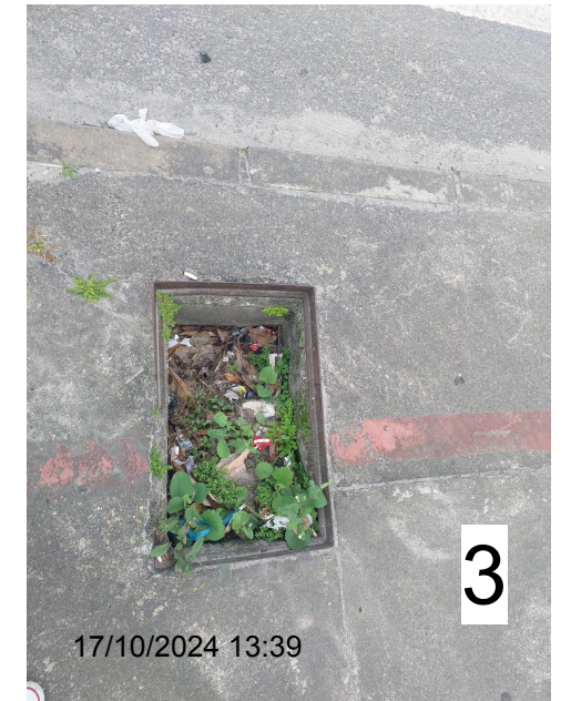
Figura 62 - Desnível na calçada
