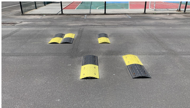
Figura 37 – Local de instalação das lombadas por parte do LAV
