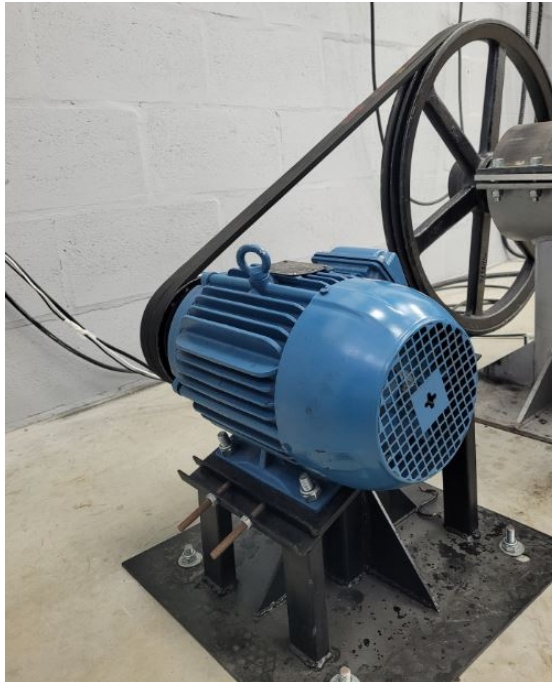
Figura 18 – Sistema motriz montado na bancada
