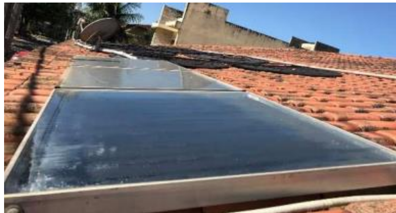
Figura 10 - Coletores solares térmicos instalados no telhado de uma residência
