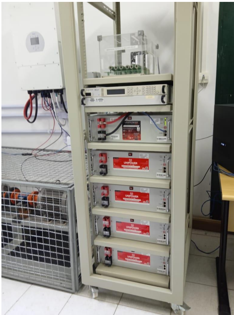
Figura 71 - Bateria conectada ao sistema
