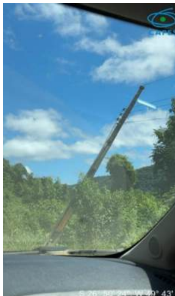
Figura 27: Poste caindo próximo a estrada devido o rastejo causado pelas chuvas. Fonte: Galeria da autora, 2023.
