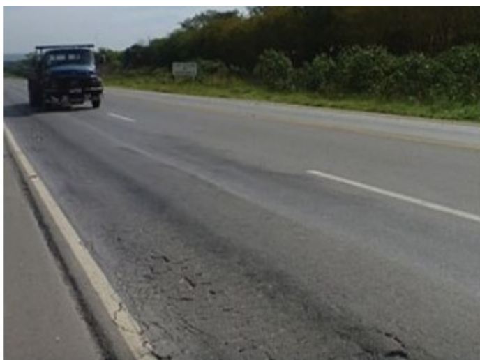
Figura 4.4 - Deformação permanente estrutural.
