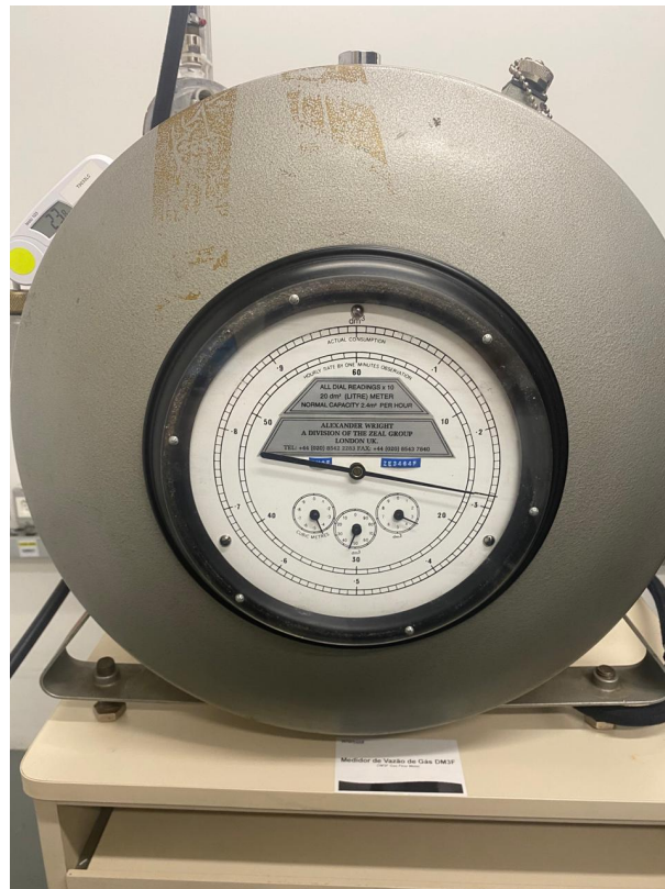
Figura 11 – Medidor de vazão.
