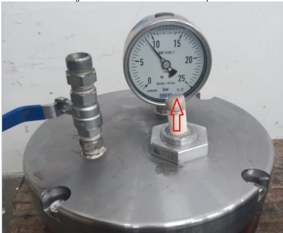
Figura 19 - Falha destrutiva da combinação
