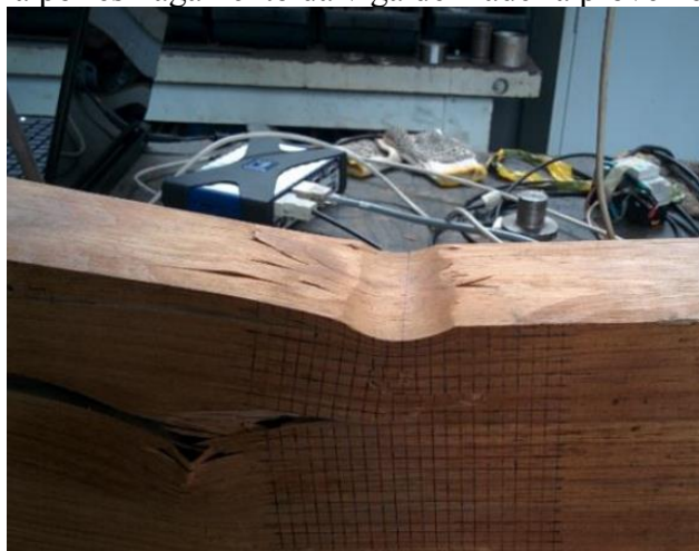
Figura 10 – Ruptura por esmagamento da viga de madeira proveniente da compressão.
