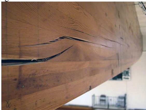
Figura 12 – Falha em cisalhamento horizontal.
