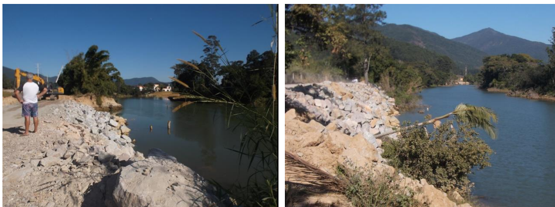
Figura 21 – partes da estrada da margem direita destruídas pela enchente, e em recuperação
