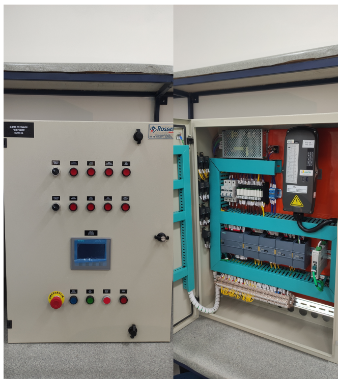
Figura 33 – Vista do painel elétrico
