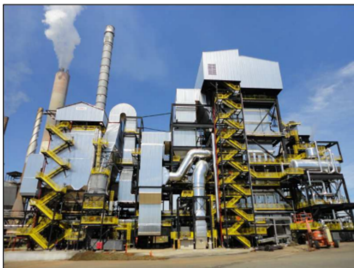
Figura 11 – Caldeira à bioamassa
